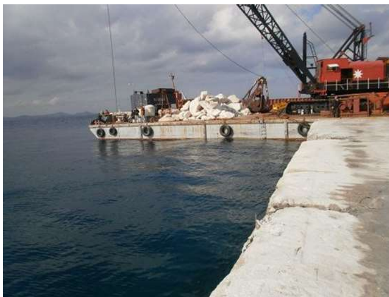
Εικόνα 3: Επισκευή λιμένα - ενίσχυση λιθορριπής και σημεία σπηλαιώσεων (CYCLADESVOiCE, 2013)
