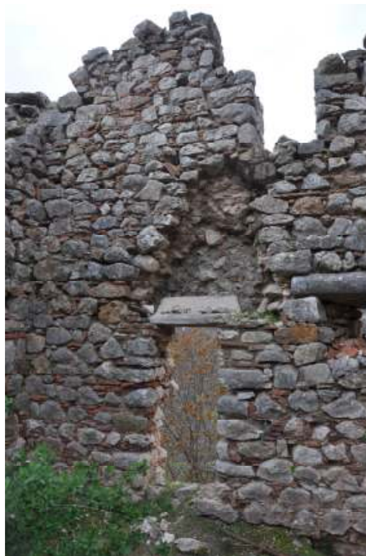
Εικ 54: Νότιο άνοιγμα εισόδου ορόφου – Κατάρρευση τμήματος τοιχοποιίας
