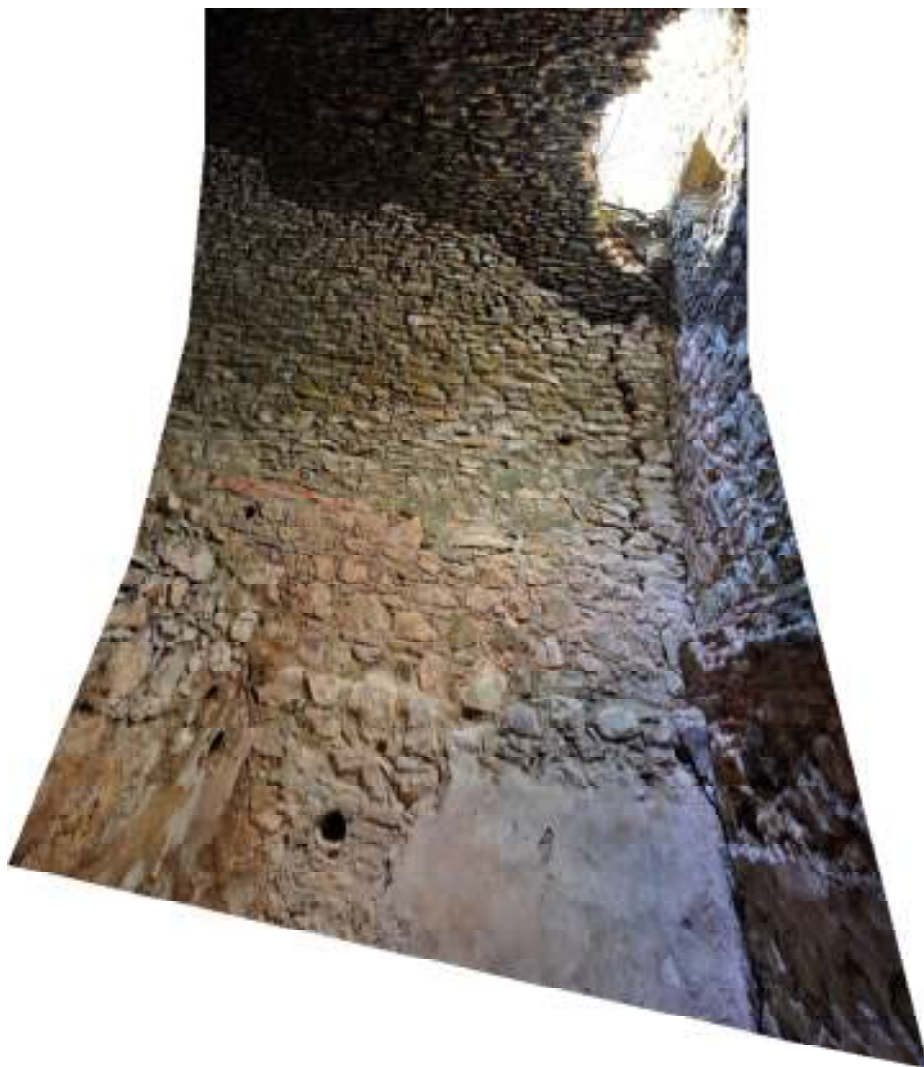
Εικ 20: Κατάρρευση βορείου άκρου θόλου – Λήψη εσωτερικά της κιστέρνας
