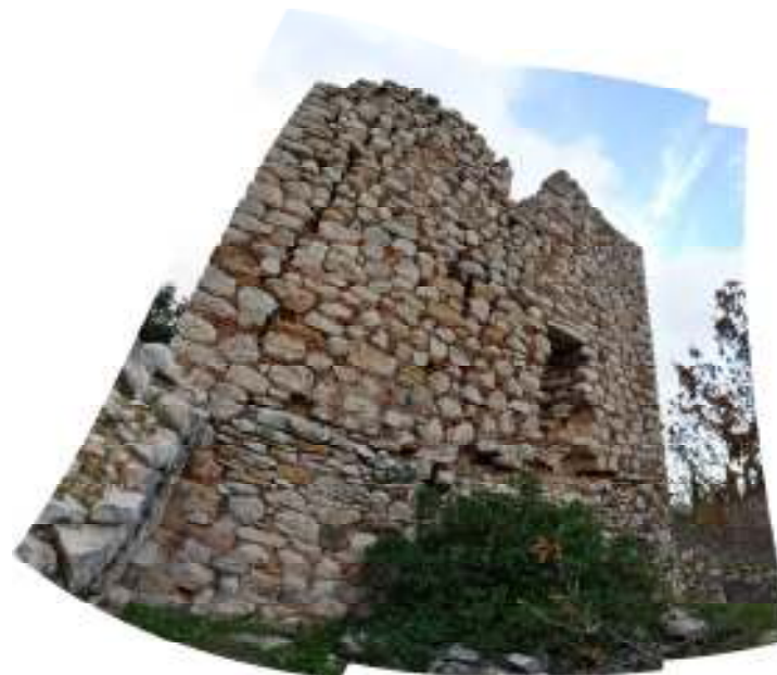
Εικ 50: Νότια όψη - Φθορές
