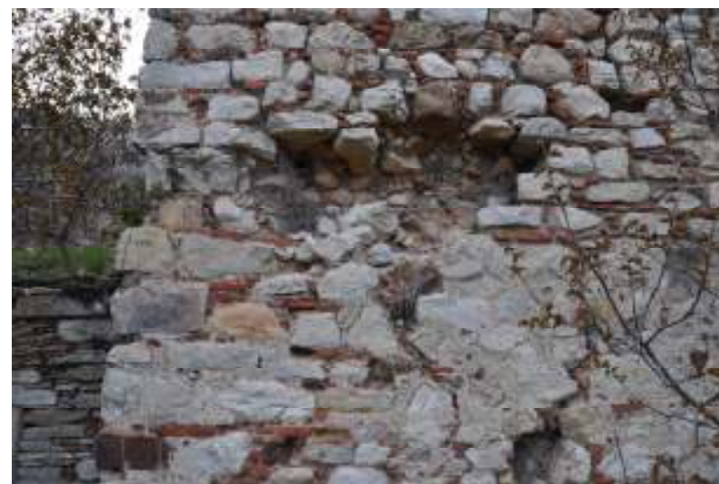
Εικ 22: Βλάβη νοτιοανατολικής εξωτερικής γωνίας
