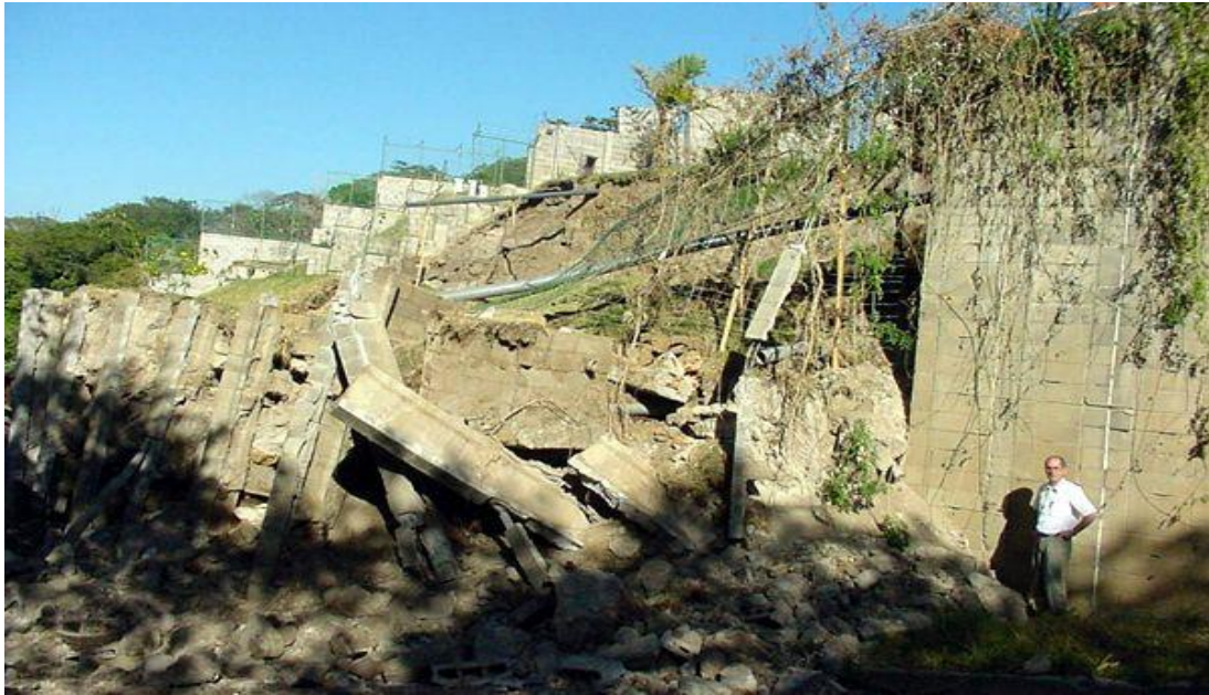
Εικόνα 1.4: Αστοχία τοίχου αντιστήριξης κατά το σεισμό του El Salvador (2001)
