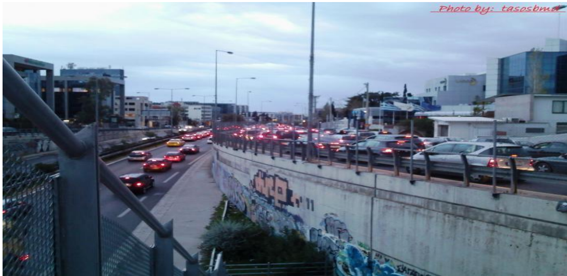
Εικόνα 1.2: Τοίχος αντιστήριξης στην Αττική οδό. Είναι προφανές ότι σε περίπτωση αστοχίας θα υπάρχουν εμφανή και εκτεταμένα προβλήματα
