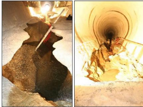
Εικόνα 4.12 Φωτογραφίες από εκτεταμένες βλάβες της σήραγγας εκτροπής.
