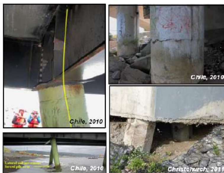
Σχήμα 1.1: Παραδείγματα αστοχίας πασσάλων λόγω ρευστοποίησης και πλευρικής εξάπλωσης σε πρόσφατους σεισμούς
