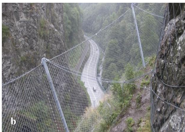
Εικόνα 2.5 Μέτρα αντιμετώπισης βραχοπτώσεων a) Μεταλλικό πλέγμα ( www.geobrugg.com ), b)Εύκαμπτος φράχτης ανάσχεσης ( www.geobrugg.com )
