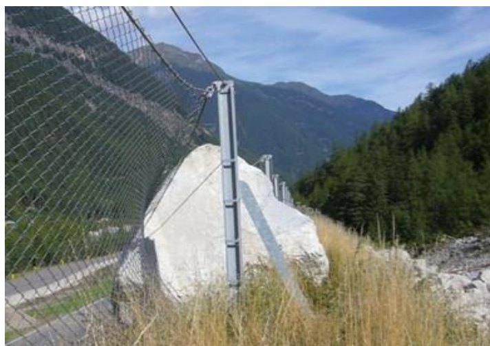
Εικόνα 2.11 Ανάσχεση βράχου από μεταλλικό φράχτη ( www.geobrugg.com )
