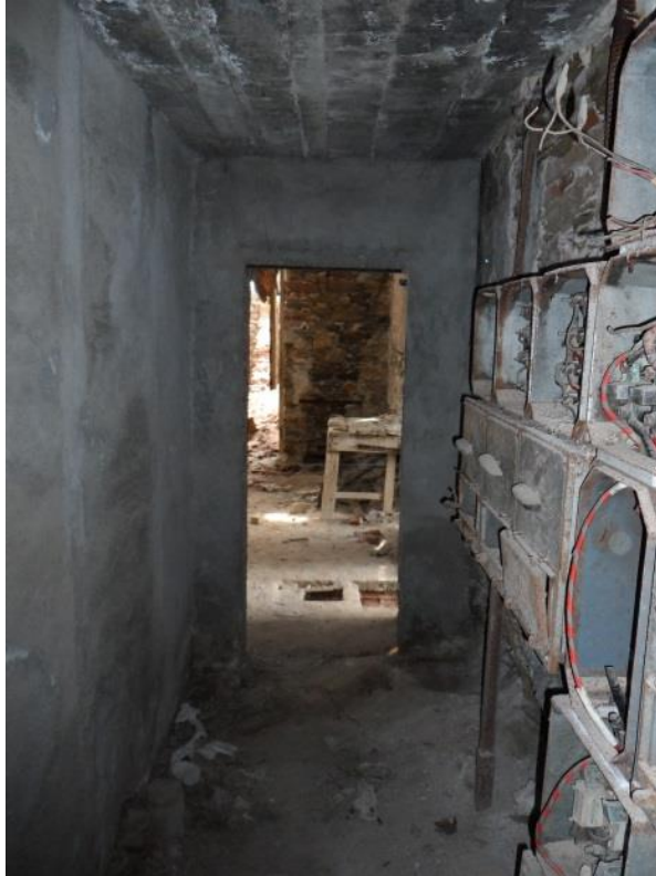
Εικόνα 77: Πίνακες ηλεκτροδότησης στον χώρο του μηχανοστασίου (πηγή: προσωπικό αρχείο)
