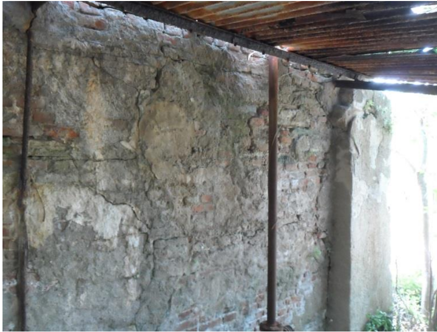
Εικόνα 190: Ρωγμές στα ψυγεία (πηγή: προσωπικό αρχείο)
