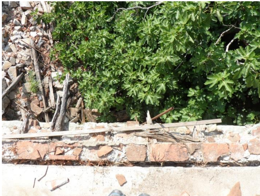
Εικόνα 174: Κομμένα πατόξυλα πάνω από τον χώρο του σαπωνοποιείου (πηγή: προσωπικό αρχείο)
