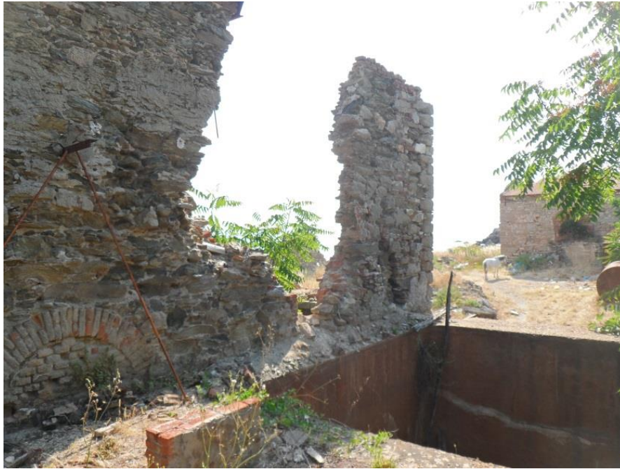
Εικόνα 188: Η κατάρρευση στον βόρειο τοίχο του εκχυλιστηρίου (πηγή: προσωπικό αρχείο)
