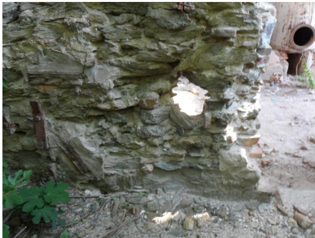
Εικόνα 204: Οπή στον βόρειο τοίχο του εκχυλιστηρίου (πηγή: προσωπικό αρχείο)
