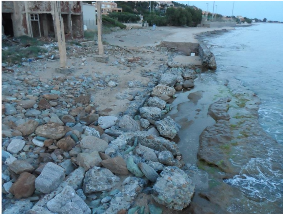
Εικόνα 123: Τα απομεινάρια του προστατευτικού τοίχου, στο βάθος φαίνεται το τμήμα του παλιού τοίχου που σώζεται με τις μπετονένιες προσθήκες (πηγή: προσωπικό αρχείο)
