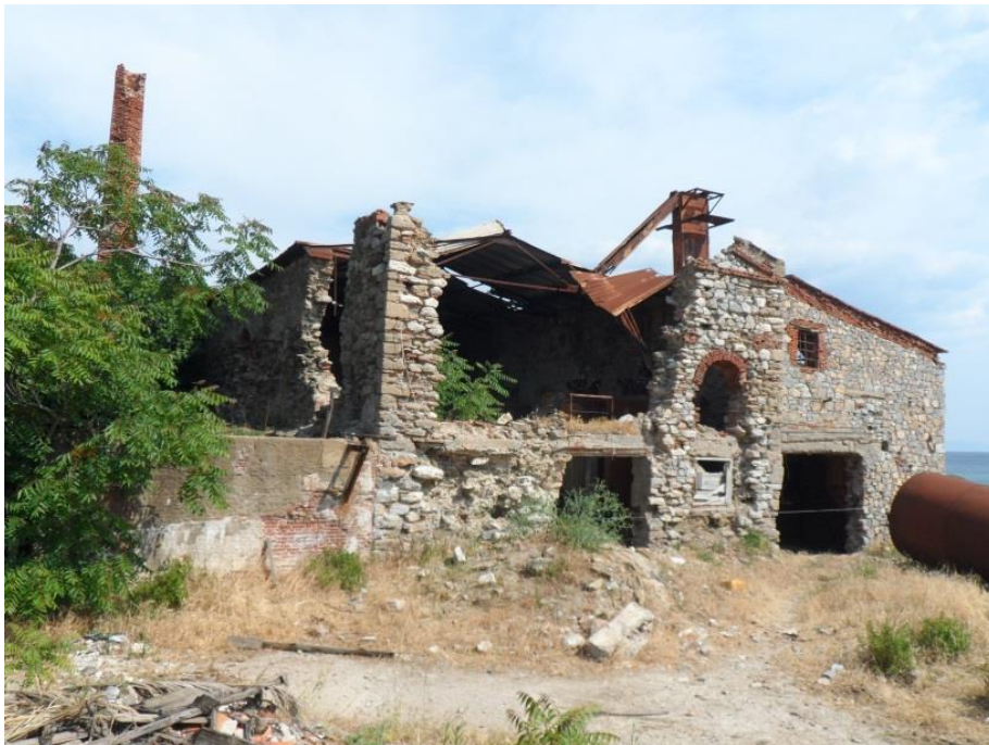
Εικόνα 187: Οι δύο μεγάλες καταρρεύσεις στο εκχυλιστήριο (πηγή: προσωπικό αρχείο)
