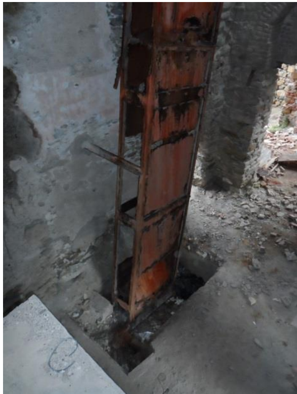
Εικόνα 78: Ηλεκτροκίνητο ανυψωτικό μηχάνημα από τον χώρο του μηχανοστασίου (πηγή: προσωπικό αρχείο)
