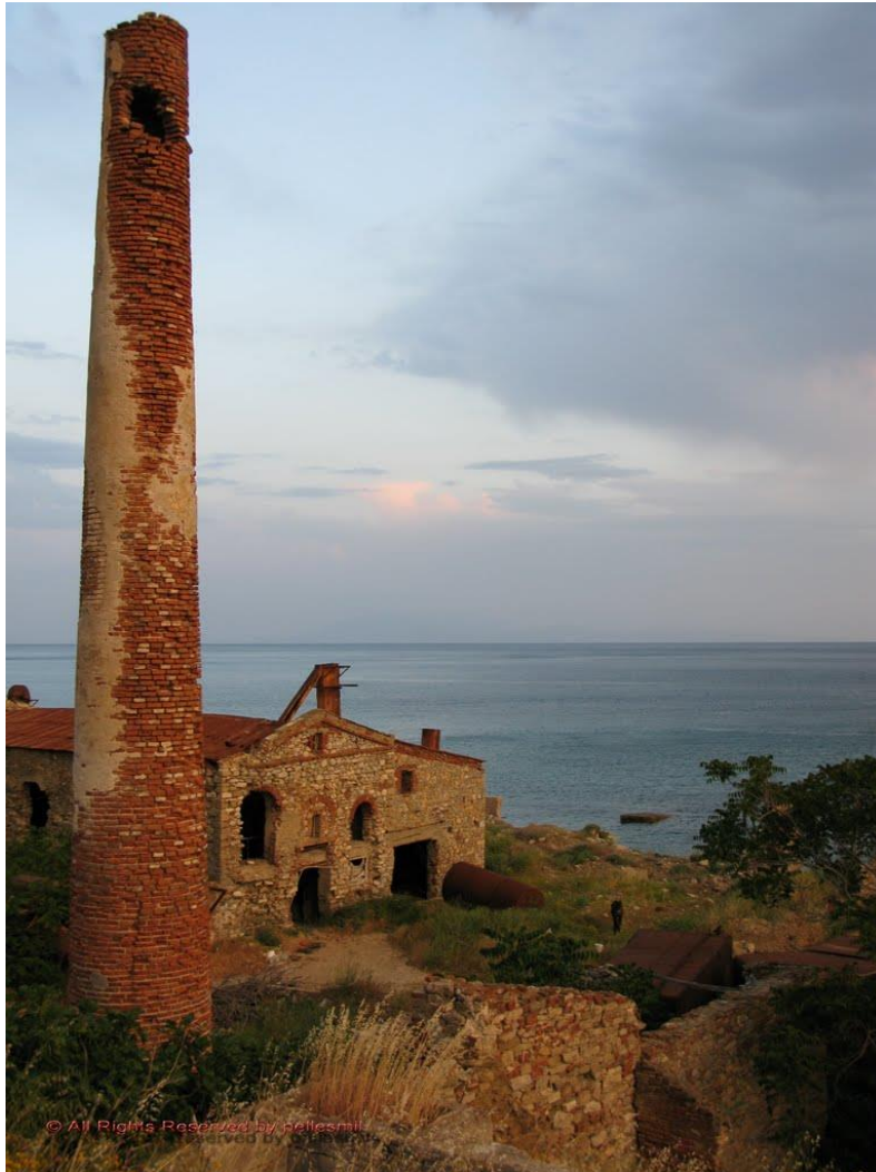
Εικόνα 177: Η δυτική όψη πριν την κατάρρευση (2009), με αρκετές επεμβάσεις αλλά διακρίνονται τα τρία μεγάλα ανοίγματα (πηγη: http://www.panoramio.com/photo/34591111 )
