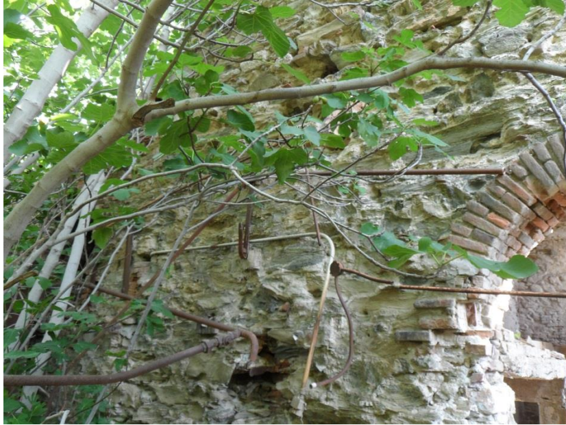
Εικόνα 198: Απομείωση του βόρειου τοίχου του εκχυλιστηρίου εξωτερικά (πηγή: προσωπικό αρχείο)
