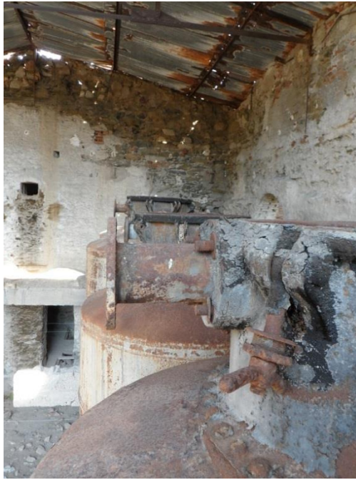
Εικόνα 200: Απομείωση του πάχους του τοίχου στον ανατολικό τοίχο του εκχυλιστηρίου (πηγή: προσωπικό αρχείο)
