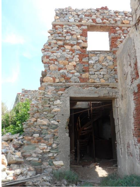
Εικόνα 186: Η κατάρρευση στον νότιο τοίχο της ραφινερίας (πηγή: προσωπικό αρχείο)
