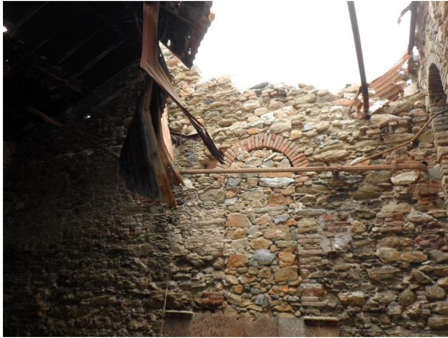
Εικόνα 196: Κατάρρευση τμήματος της στέγης του παλιού λεβητοστάσιου (πηγή: προσωπικό αρχείο)
