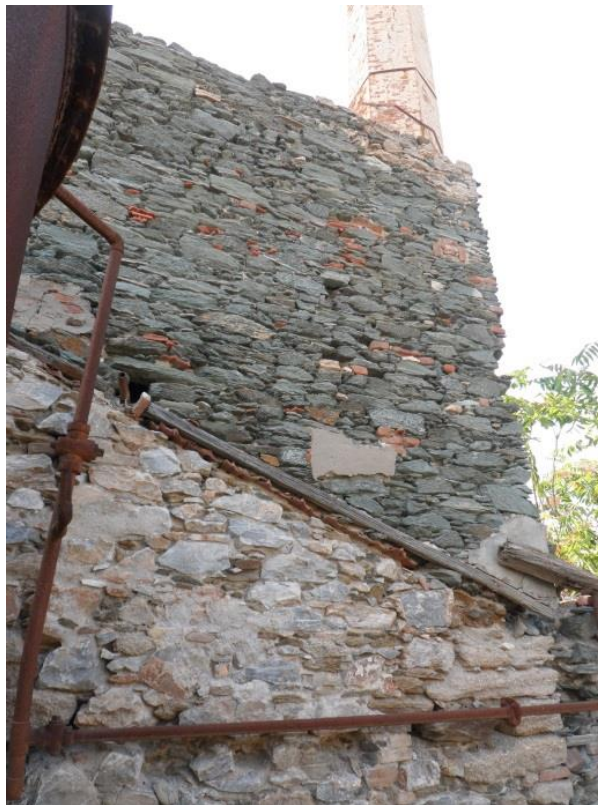
Εικόνα 86: Τα κεραμίδια κάτω από τον τοίχο που προστέθηκε πάνω στον ανατολικό τοίχο του πυρηνελαιουργείου (πηγή: προσωπικό αρχείο)
