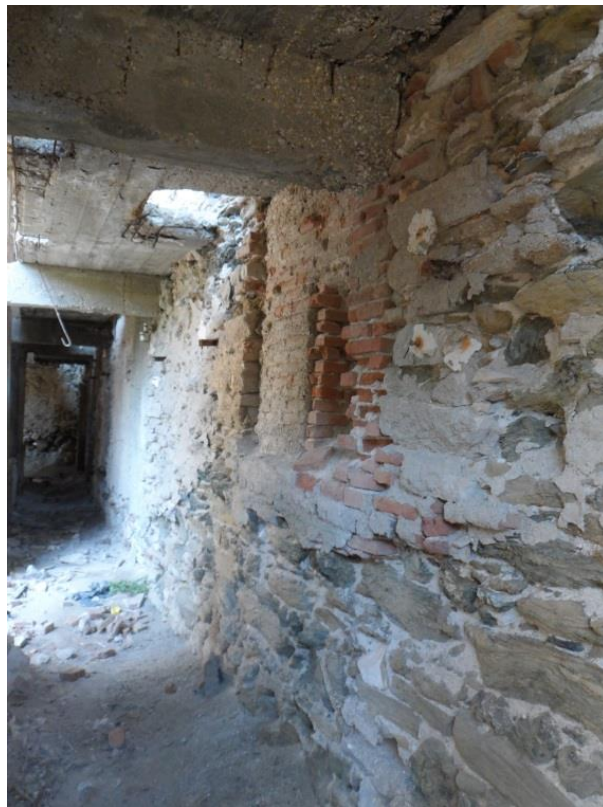
Εικόνα 199: Η διάβρωση των λίθων στον νότιο τοίχο του εκχυλιστηρίου εσωτερικά (πηγή: προσωπικό αρχείο)
