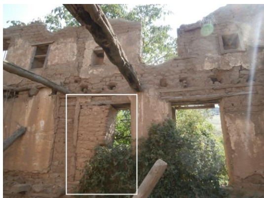
Φωτογραφία 7.1. Μεταγενέστερο κλείσιμο του ανοίγματος στα βόρεια του πεσσού D4
