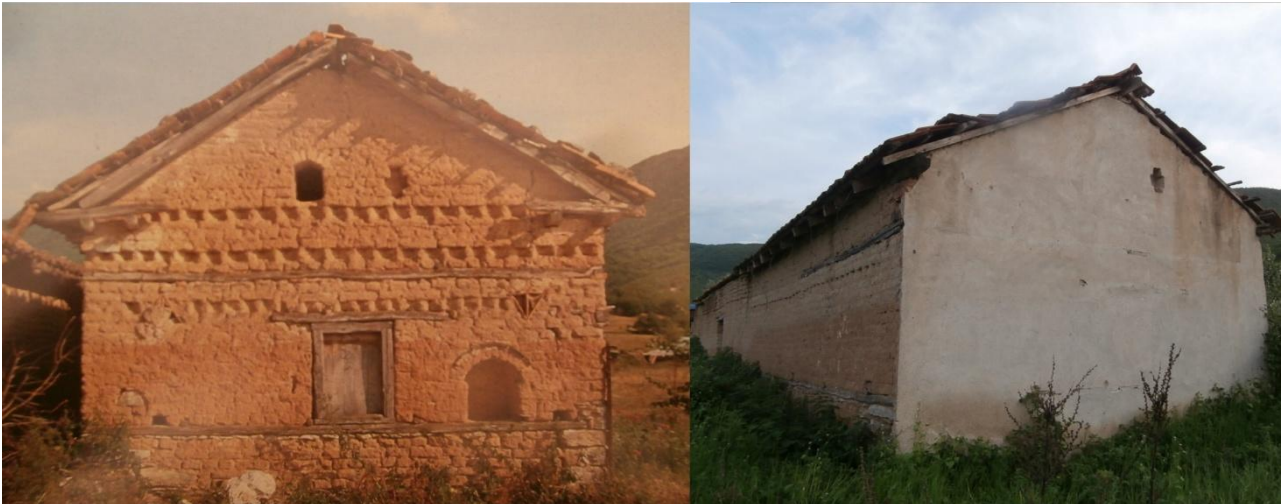
Φωτογραφία 5.19. Είναι εμφανής η πρόθεση του ιδιοκτήτη της αποθήκης στον οικισμό Οξιά Πρεσπών να καλύψει τον ανάγλυφο διάκοσμο της –σήμερα – αποθήκης. Η διακόσμηση, ωστόσο, φανερώνει πως το ισόγειο μακρόστενο αυτό κτίσμα αποτελεί μάρτυρα της πρώτης μορφής κατοικίας στην περιοχή. (πηγή φωτ. αριστερά: [12])
