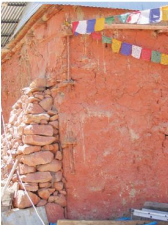
Εικόνα 3.10. Τοποθέτηση οριζόντιων ξύλινων ελκυστήρων στην εξωτερική επιφάνεια της τοιχοποιίας. Ναός στο χωριό Νάκο, στο Κινάρ της Ινδίας [113]
