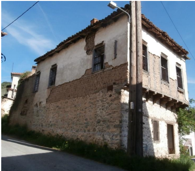
Φωτογραφία 5.7. Σταδιακή αποκόλληση των εξωτερικών επιχρισμάτων. Κτίριο στο Ανταρτικό.
