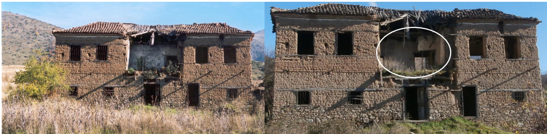
Φωτογραφία 5.14. 2005 (αριστερά) – 2015 (δεξιά). Η εικόνα του κτιρίου Β παραμένει σχετικά αναλλοίωτη. Ο ασθενώς συνδεδεμένος μπαγδατότοιχος είναι η μόνη 'απώλεια'.
