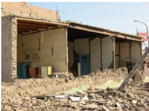
Εικόνα 3.2. Ανατροπή τοιχοποιίας της κύριας όψης. Καθώς η στέγη στηρίζεται στους εγκάρσιους τοίχους παρέμεινε στη θέση της, Πίσκο, Περού 2007 [68]
