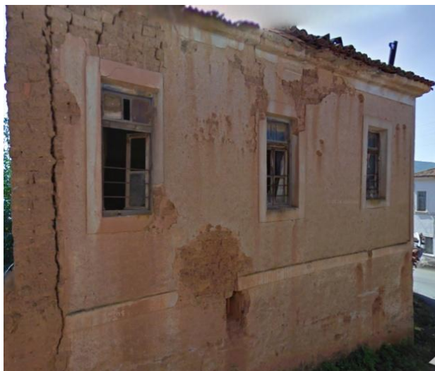
Φωτογραφία 5.1. Η δημιουργία κατακόρυφης στήλης πλιθιών συνεπάγεται μεγάλο κίνδυνο εκτός επιπέδου κατάρρευσης. Διακρίνονται και ρωγμές με σημείο εκκίνησης το μεσαίο άνοιγμα. Κτίριο στη Χαλάρα.
