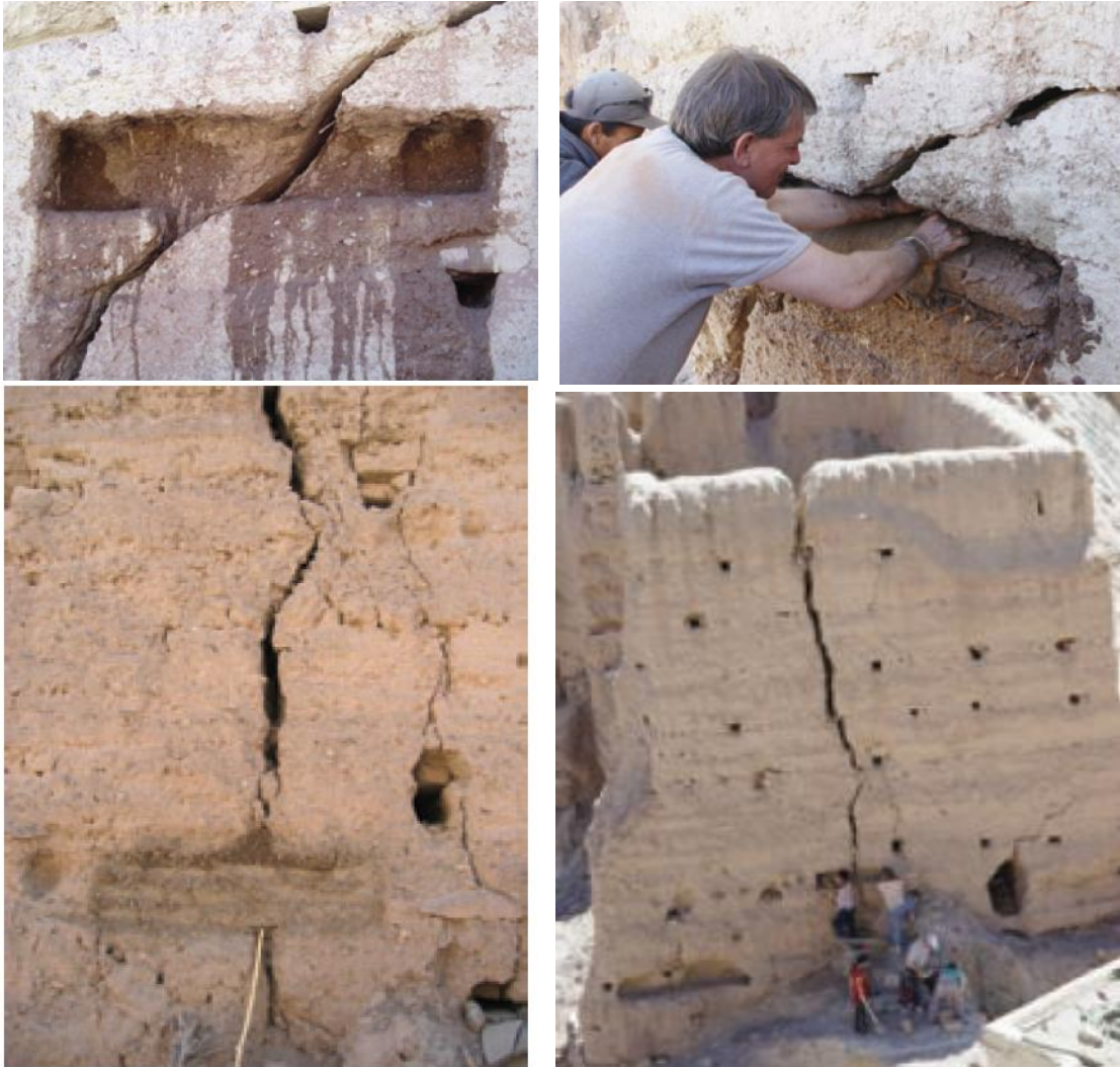
Εικόνα 3.5. Δημιουργία τομής για τη συρραφή της ρωγμής και γέμισμα της, με τη μέθοδο soft stitching . Η διαδικασία θα επαναληφθεί σε πολλαπλά σημεία της ρωγμής (από την περιοχή Ladakh, στη βόρεια Ινδία) [73]
