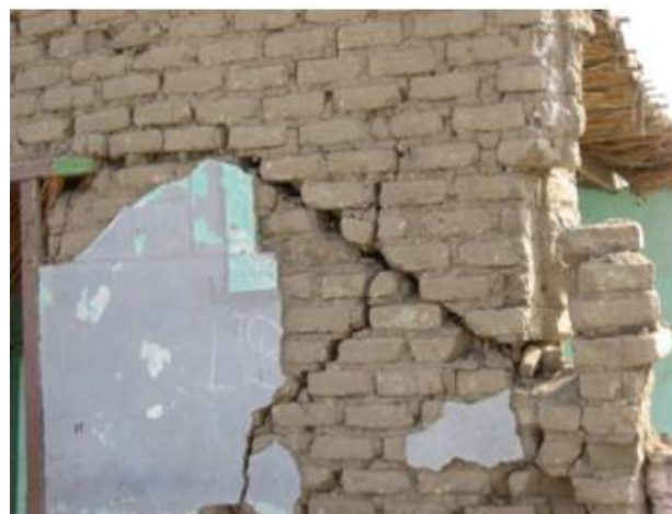
Εικόνα 3.3. Τυπική χιαστί ρωγή, λόγω εντός επιπέδου σεισμικής δράσης, Πίσκο, Περού 2007 [68]
