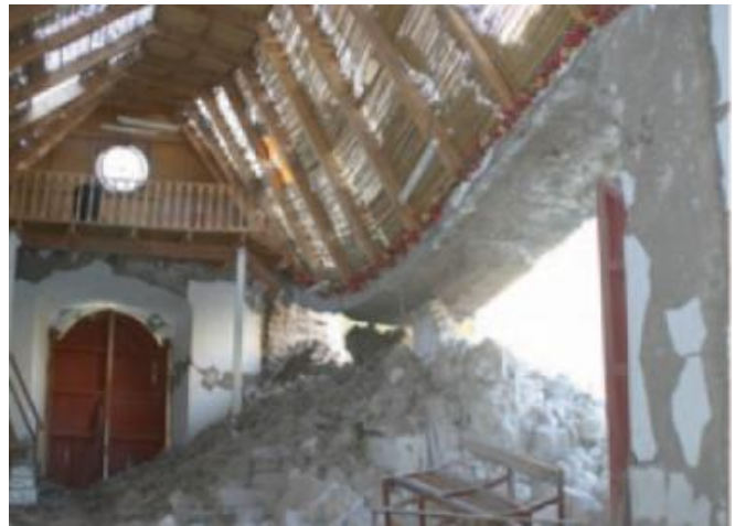
Εικόνα 3.9. Το καμπτόμενο περιμετρικό διάζωμα από οπλισμένο σκυρόδεμα κατέστρεψε τοιχοποιία από ωμόπλινθους πάχους 1.3μ. Καθεδρικός Tataraca, Χιλή 2005
