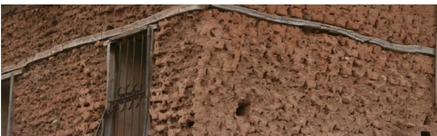
Φωτογραφία 5.6. Εικόνα «διάτρητης» τοιχοποιίας λόγω μακροχρόνιας έκθεσης στη βροχή. Λευκίνας Πρεσπών.
