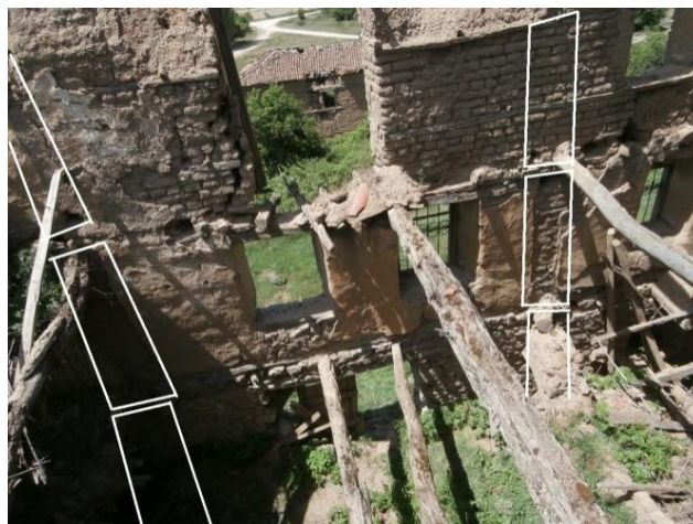
Φωτογραφία 4.7. Πλήρης αποκόλληση των εσωτερικών τοίχων του κτ. Α εξαιτίας της απουσίας σύνδεσης με την εξωτερική
