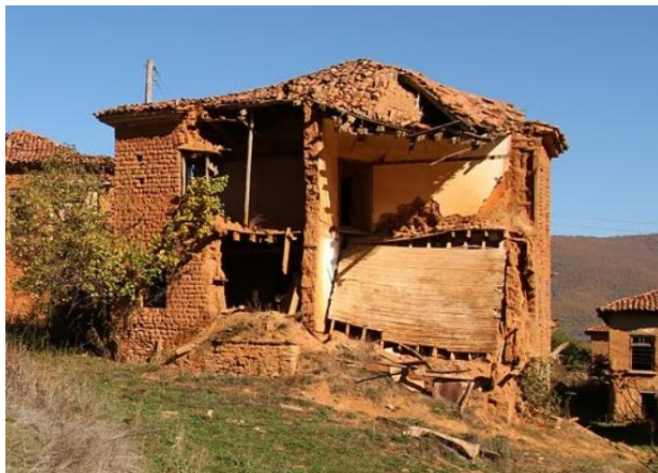
Φωτογραφία 5.2. Αποκόλληση της εξωτερικής τοιχοποιίας λόγω απουσίας σύνδεσης με τους εσωτερικούς εγκάρσιους τοίχους. Κτίριο στον Κρανιώνα
