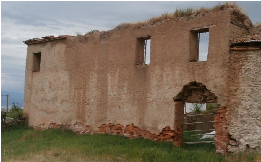
Φωτογραφία 5.4. Η απουσία λίθινης βάσης (ή η άνοδος της στάθμης του εδάφους) επέτρεψε τη δράση της ανερχόμενης υγρασίας και την επιφανειακή εμφάνιση αλάτων. Είναι εμφανής και η ανάπτυξη βλάστησης στη στέγη του τοίχου.
