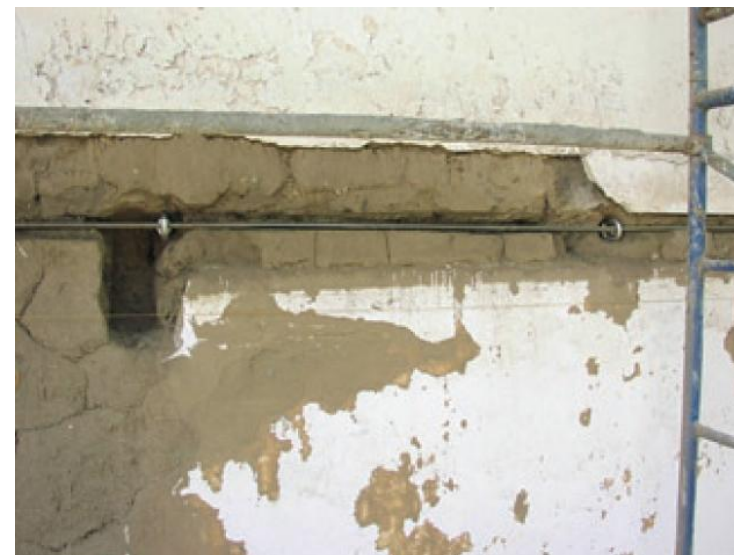
Εικόνα 3.13. Ιμάντας από ανοξείδωτο χάλυβα που δέθηκε στις δοκούς του πατώματος με κοχλίες ανάρτησης, Las Flores Adobe, Καλιφόρνια [118]
