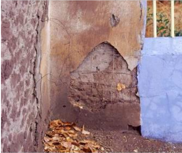
Εικόνα 3.8. Ρηγματωμένο επίχρισμα που τοποθετήθηκε επί χαλύβδινου ενισχυτικού πλέγματος [81]
