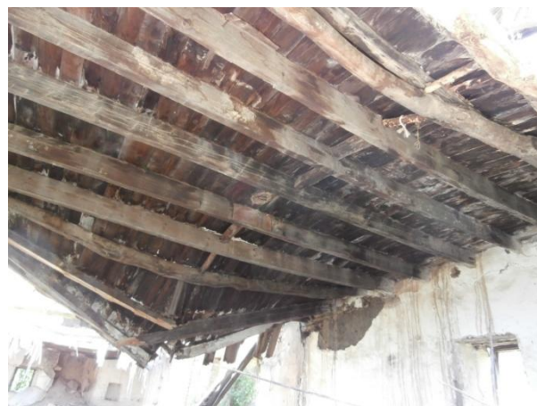
Φωτογραφία 4.12. Μεταγενέστερα τοποθετημένες, καλά πελεκημένες δοκοί, ορθογωνικής διατομής. Μικρά ξύλινα στοιχεία αποσκοπούν, πιθανά, στην μεταξύ των γρεντιών σύνδεση.
