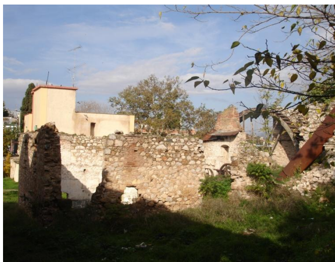
εικ. 78: καταρρεύσεις ανατολικού τοίχου
