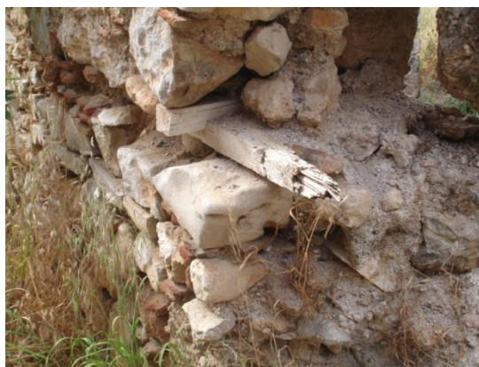
εικ. 73: ξυλοδεσιές από τη νοτιοανατολική γωνιά που έχει καταρρεύσει
