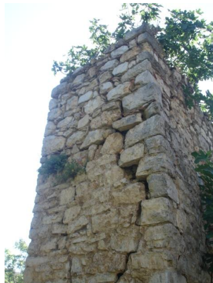
εικ. 79: ρωγμές στη βορειοανατολική γωνιά του τοίχου που περιβάλλει τη φτερωτή
