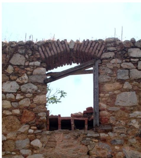
εικ. 74: άνοιγμα δυτικού τοίχου
