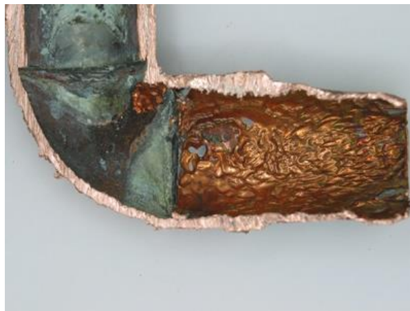
Εικόνα 1.2: Διάβρωση Μεταλλικού σωλήνα
