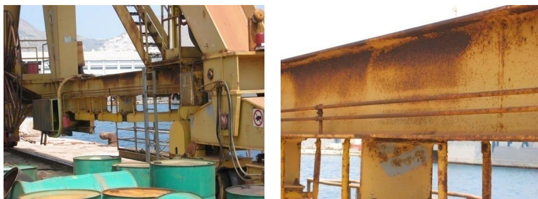
Εικόνα 6.4: Διάβρωση σε μια μονάδας ανέλκυσης πλοίου (στην γερανογέφυρα ανέλκυσης).
