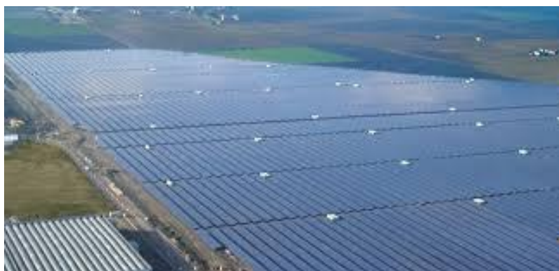
Σχήμα 11: Φωτοβολταϊκή εγκατάσταση μεγάλης κλίμακας
