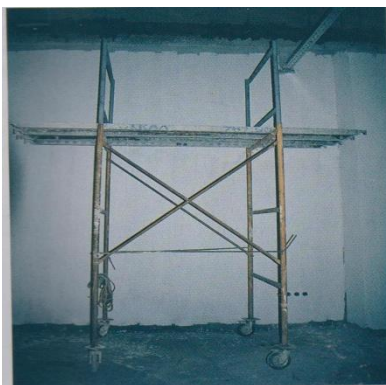
Φωτ #5.12.1# Πύργος χωρίς προστασία έναντι πτώσης και με ακατάλληλη πρόσβαση.
