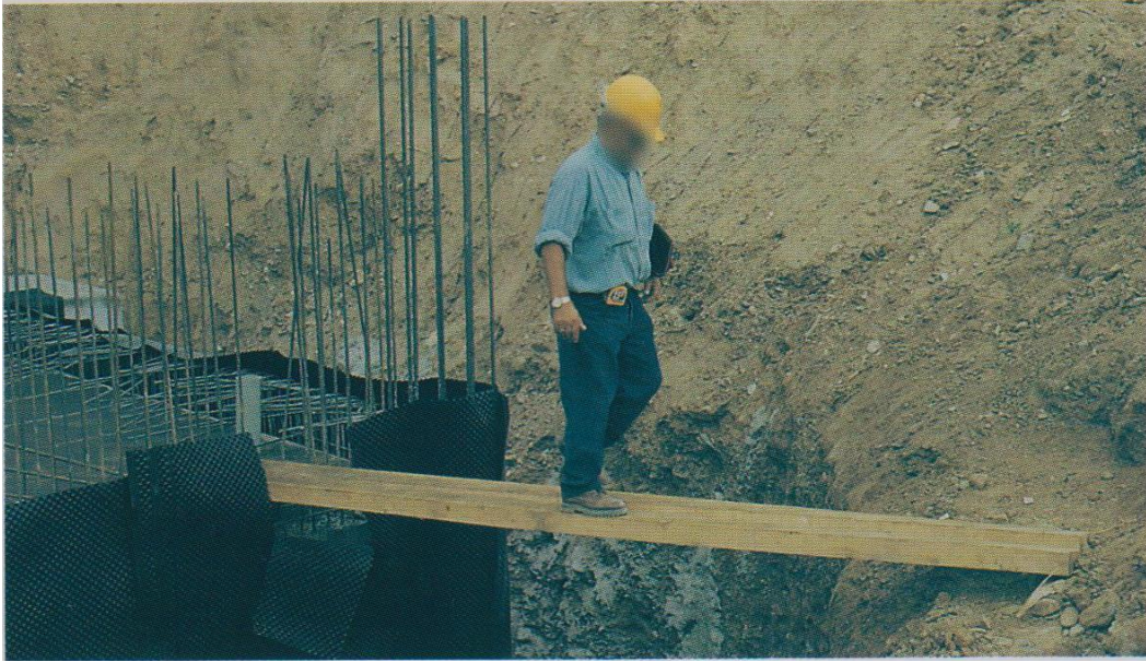
Φωτ #5.14.2# Γεφύρωμα χωρίς προστασία έναντι πτώσης ακατάλληλου πλάτους, ([3])
