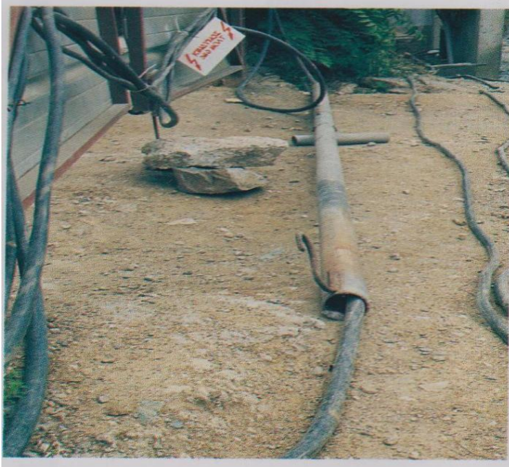
Φωτ. #5.4.1#: Κατάλληλη προστασία καλωδίου από διέλευση οχημάτων-υλικών,
