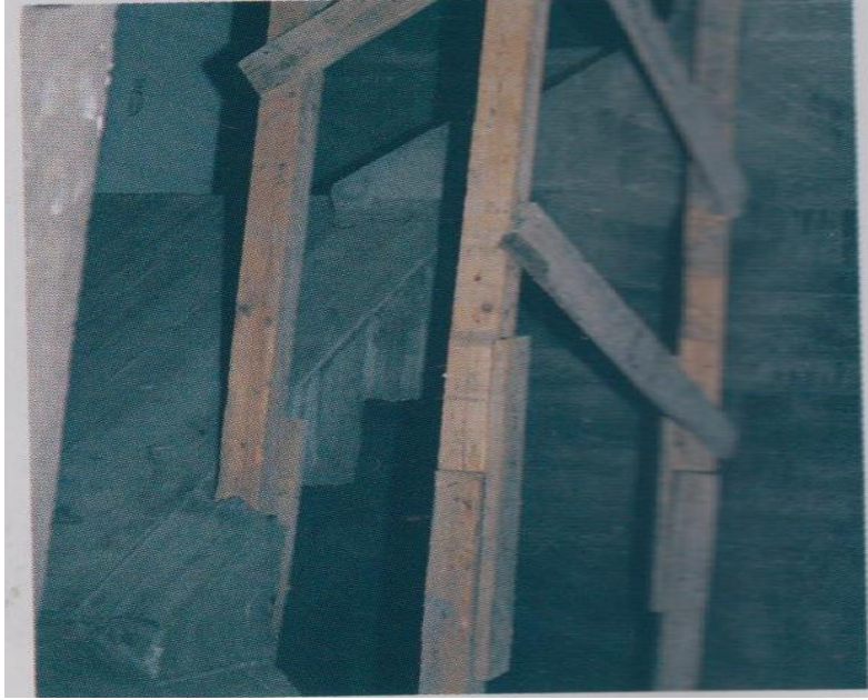
Φωτ #5.7.3.# Καλή προστασία κλιμακοστασίου, ([3])
