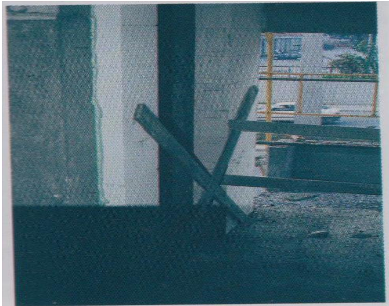
Φωτ #5.7.4.# Κακή προστασία φρεατίου ασανσέρ, ([3])
