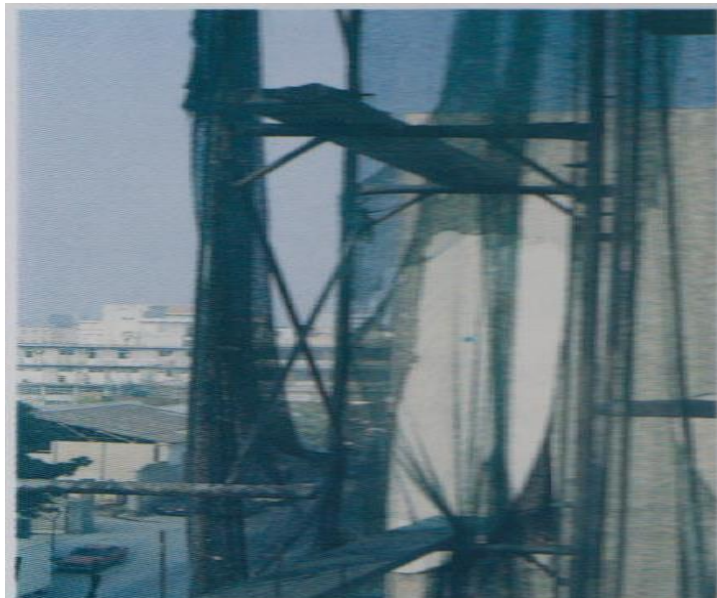
Φωτ #5.10.1.# Δάπεδο εργασίας ανεπαρκούς πλάτους, ([3])
