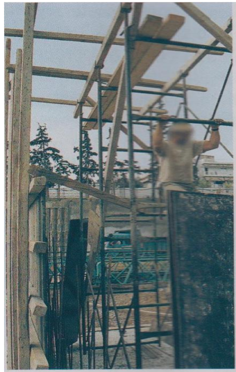
Φωτ #5.11.3# Σκαλωσιά με ακατάλληλη πρόσβαση στα δάπεδα εργασίας, ([3])
