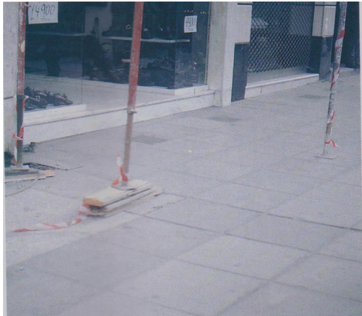
Φωτ #5.11.1# Ακατάλληλη έδραση σκαλωσιάς (αριστεροί ορθοστάτες), ([3])
