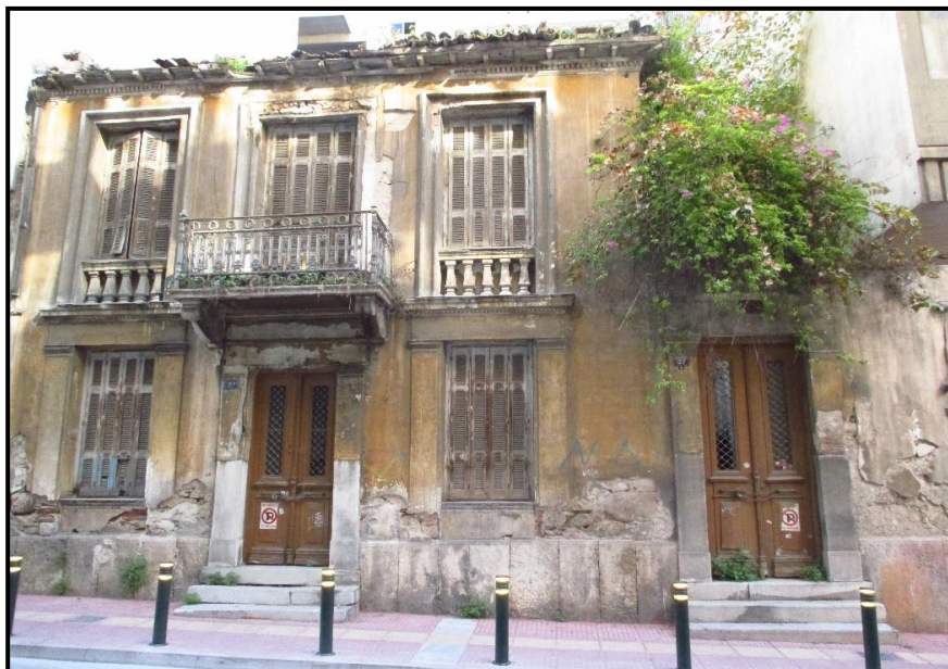
Εικόνα 3.6: Διατηρητέο κτίριο κακής δομικής κατάστασης στην οδό Νοταρά 97, 97Α
