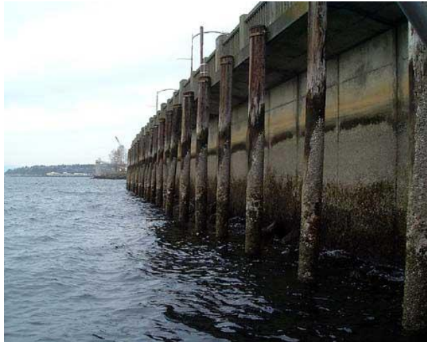
«Διάβρωση σε Θαλασσιο Φράγμα στην Αλάσκα» 5
