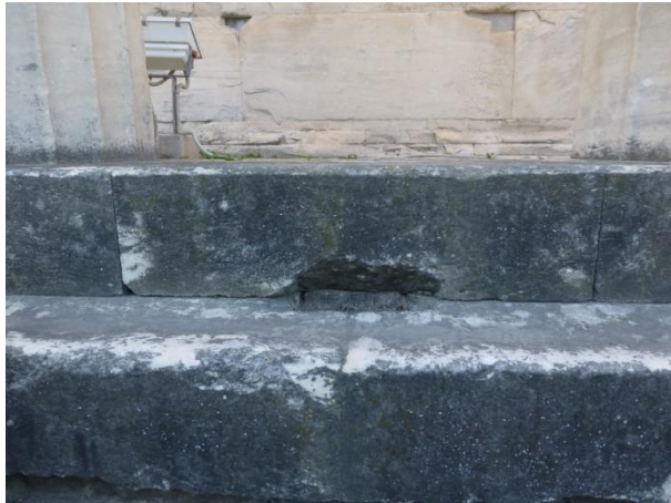
Εικόνα 3.1.4-25: Φωλιές στη βόρεια όψη. Από το χρώμα των λίθων διαπιστώνεται και η εκτεταμένη βιοδιάβρωση σε αυτή την όψη.
