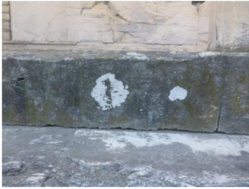
Εικόνα 3.1.4-26: Βιοδιάβρωση στη βόρεια όψη
