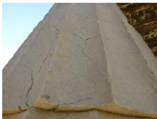
Εικόνα 3.1.4-14: Ρηγματώσεις στη βόρεια πλευρά εξαιτίας της έκπλυσης προσμίξεων
