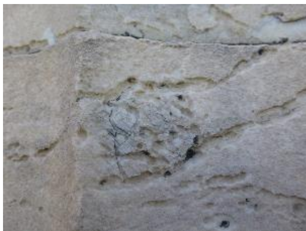
Εικόνα 3.1.4-17: Βελονοειδής διάβρωση λόγω έκλυσης προσμίξεων - Ενδολιθική βιοδιάβρωση
