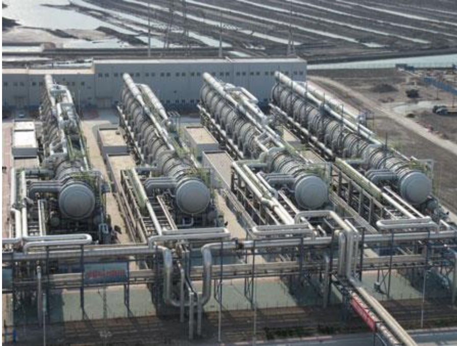
ΦΩΤ. 2.2.1: ΠΟΛΥΒΑΘΜΙΑ ΕΓΚΑΤΑΣΤΑΣΗ
