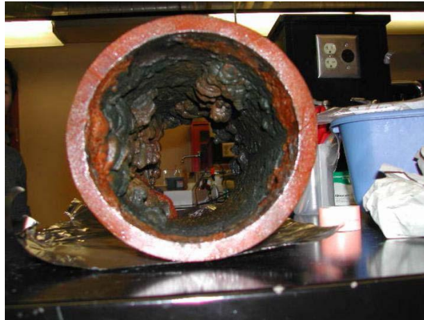
Σχήμα 2.5-Διάβρωση αγωγού με σοβαρή μείωση της διαμέτρου
