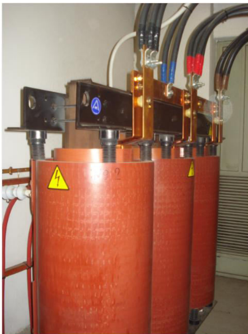
Σχήμα 8: Μετασχηματιστής υποβιβασμού ξηρού τύπου 20kV/0.4kV/230V
