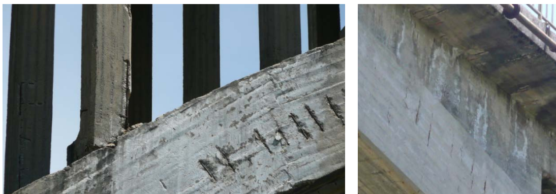
Εικ. 2.40,41 : Γενική εικόνα φθορών στο άνοιγμα και στην κορυφή του τόξου
