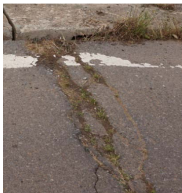
Εικ. 2.42 : Αποδιοργάνωση ασφαλτοτάπητα σε θέση αρμού
