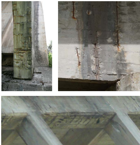
Εικ. 2.36-38 : Οξείδωση οπλισμών στη βάση τόξου, στην έδραση αμφιέριστης δοκού και στο άνοιγμα δοκού καταστρώματος
