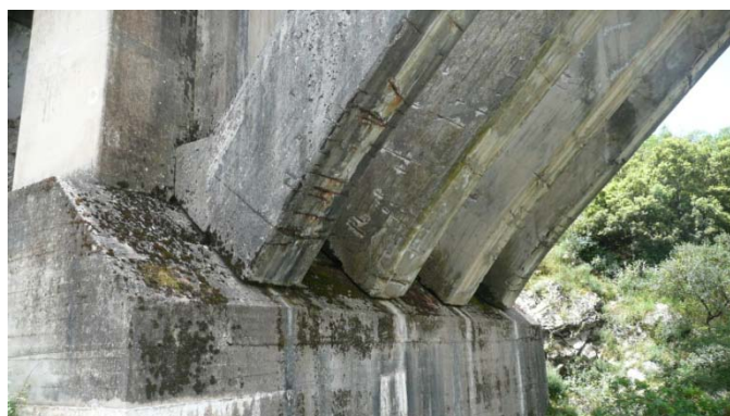
Εικ. 2.39 : Γενική εικόνα φθορών στη βάση του βορείου μεσοβάθρου (εξανθήσεις αλάτων, απώλεια επικαλύψεων, διάβρωση οπλισμού, χρωματική αλλοίωση από χημικές και βιολογικές επικαθίσεις
