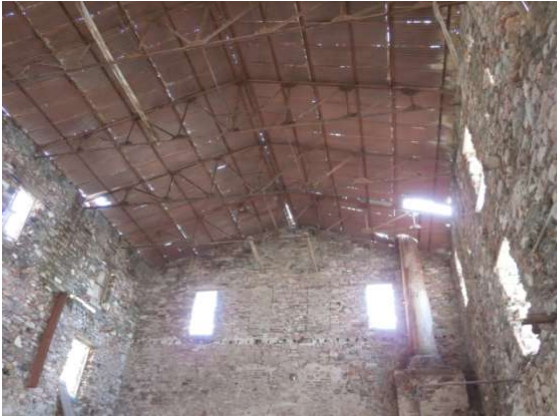
Εικόνα 33 : Σαπωνοποιείο Ξεπετρά στο Πλωμάρι, κατακόρυφα μεταλλικά κλειδιά για να πιαστεί η στέγη με την τοιχοποιία
