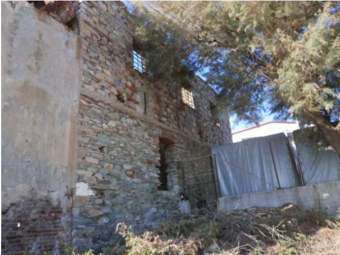
Εικόνα 1 Σφάλμα! Δεν έχει καθοριστεί ακολουθία. : Η ανατολική όψη της ραφινερίας, διακρίνεται το σενάζ στη στέψη του ισογείου
