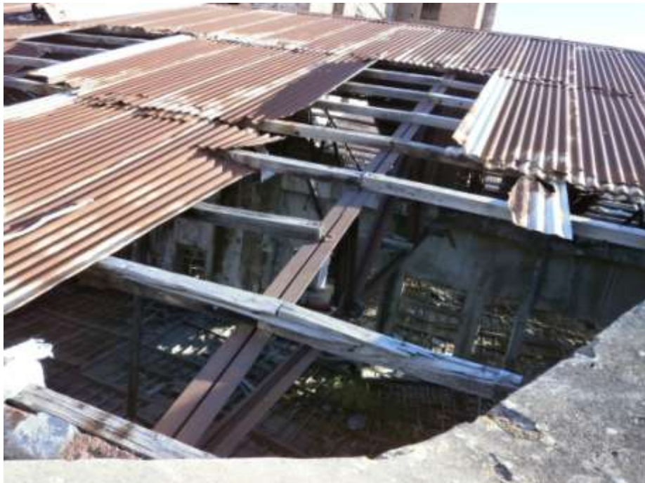
Εικόνα 30 : Βιομηχανικό συγκρότημα Καλαμάρη στη Μυτιλήνη, μεταλλικός φορέας στέγης από διπλα γωνιακά, ξύλινες τεγίδες και επικάλυψη από λαμαρίνα
