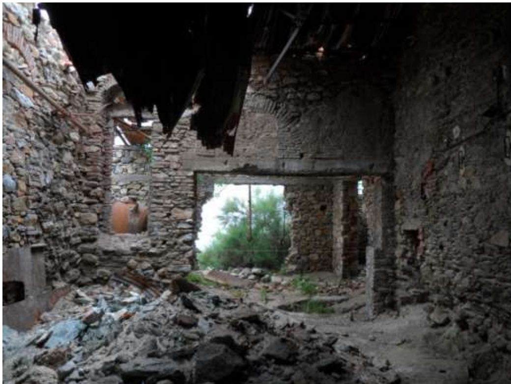
Εικόνα 25 : Κατάρρευση του δυτικού τοίχου του σαπωνοποιείου παρασύροντας τη στέγη του παλιού λεβητοστασίου
