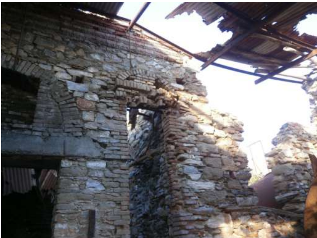
Εικόνα 11 : Η νότια όψη του λεβητοστασίου, διακρίνονται τα αποδιοργανωμένα πλίνθινα τοξωτά ανοίγματα, οι επεμβάσεις με Ο/Σ στη κεντρική θύρα, ο νότιος τοίχος του σαπωνοποιείου που έχει καταρρεύσει και η μη σύνδεση τους
