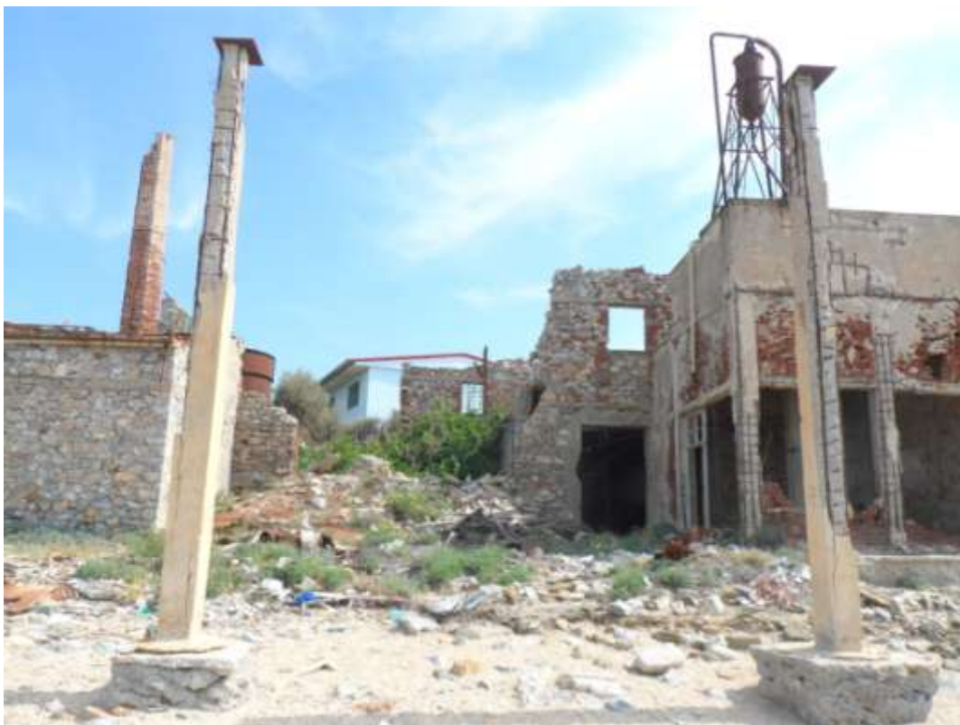
Εικόνα 22 : Η κατάρρευση του νότιου και βόρειου τοίχου του σαπωναποιείου
