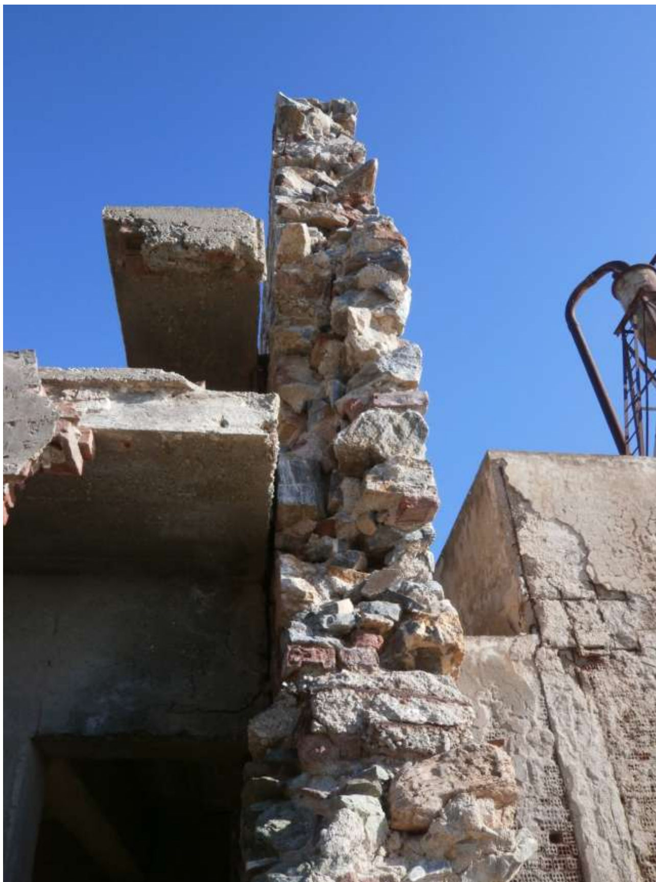
Εικόνα 19 : Καθ' ύψος τομή της νότιας τοιχοποιίας της ραφινερίας, σενάζ στην αλλαγή του ορόφου
