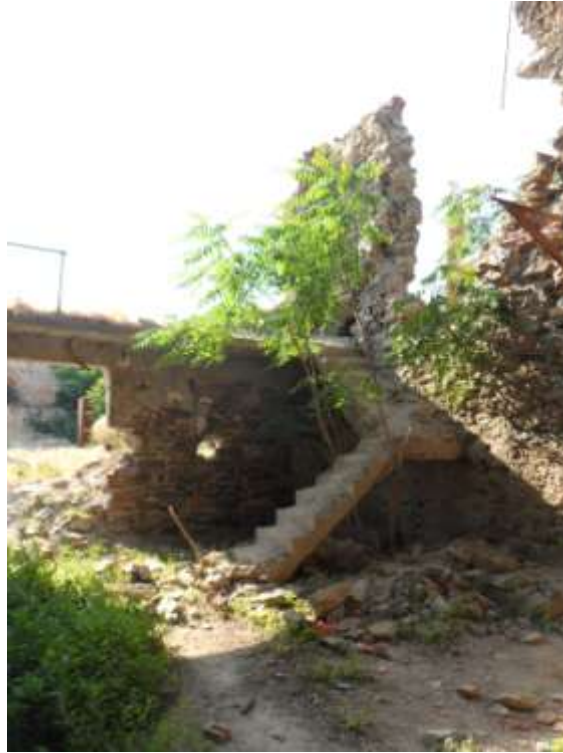
Εικόνα 21: Κατάρρευση τοιχοποιίας ορόφου ΒΔ γωνίας
