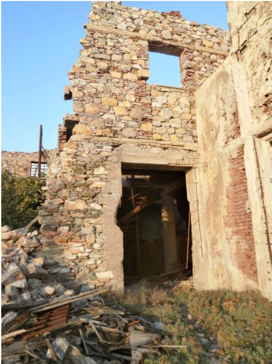
Εικόνα 12 : Νότια όψη της ραφινερίας σε επαφή με τη δεξαμενή της θάλασσας. Διακρίνονται το σενάζ από Ο/Σ στη στάθμη των πρεκιών του ορόφου αλλά και ο δυτικός τοίχος που έχει καταρρεύσει
