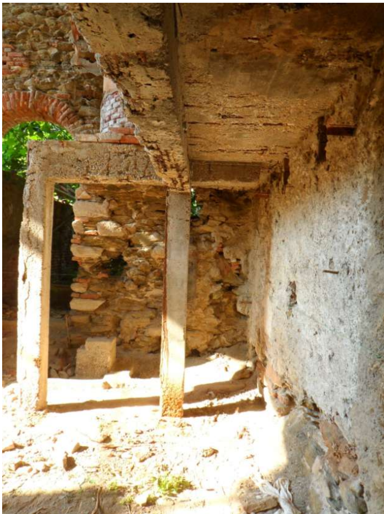
Εικόνα 20 : Διάβρωση οπλισμού στο πατάρι του εκχυλιστηρίου
