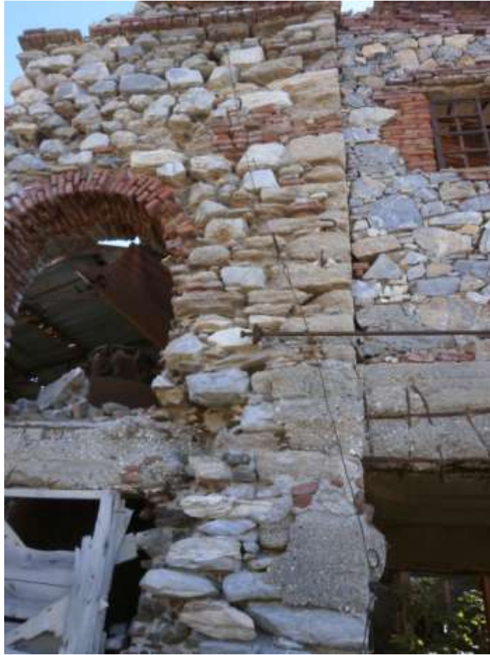
Εικόνα 6 : Σημείο ένωσης του εκχυλιστηρίου με το ξηραντήριο, ο νότιος τοίχος απλά ακουμπάει, διακρίνεται δοκός από Ο/Σ στη μέση του ύψους του ανοίγματος
