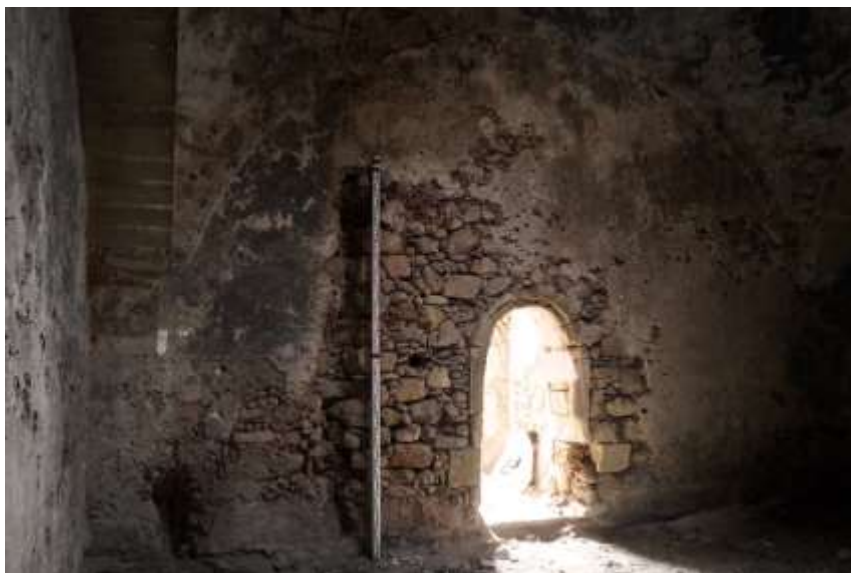
32. Ανατολικός τοίχος θερμής αίθουσας (Θ). Το άνοιγμα οδηγεί στον προηγούμενο χώρο, το χλιαρό. Εξ αιτίας τοπικών καταρρεύσεων διακρίνονται 2 κατακόρυφοι πήλινοι αγωγοί – καπνοδόχοι.
