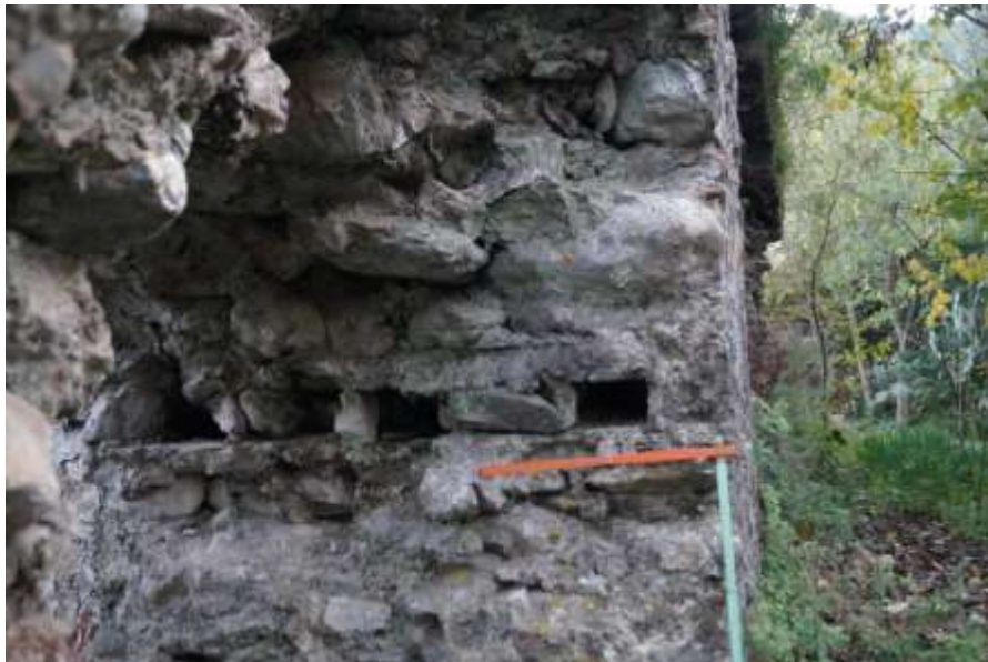
11. Εντοπισμός τεσσάρων ξυλοδεσιών κατά το πάχος του τείχους.
