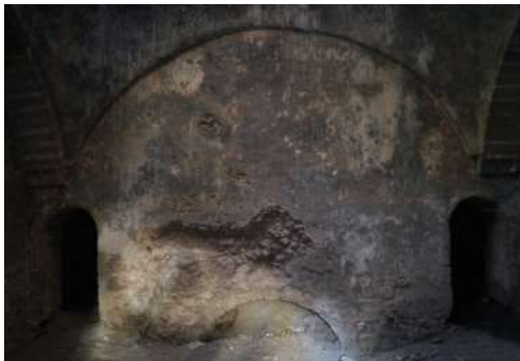
23. Θερμή αίθουσα (Θ). Ανατολικός τοίχος. Δύο θυρώματα προς τα ατομικά δωμάτια (H1 και H2). Κεντρικά χαμηλά ημικυκλικό άνοιγμα και ακριβώς από πάνω τοπική κατάρρευση- απολάκυψη τμήματος από το σύστημα των πήλινων αγωγών. Φαίνεται το χαμηλό τμήμα της θολοδομίας.
