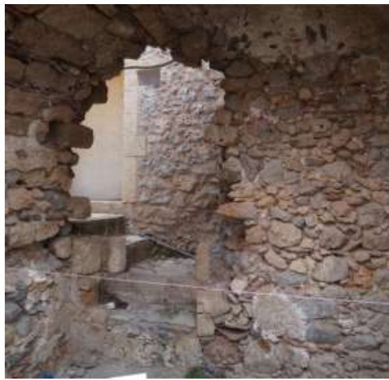
6. ΒΔ γωνία αποδυτηρίου. 'Ανοιγμα στο βόρειο τείχος σε άσχημη κατάσταση. Χαμηλά φαίνεται διαμορφωμένη εσοχή με αντικριστά κεραμίδια.
