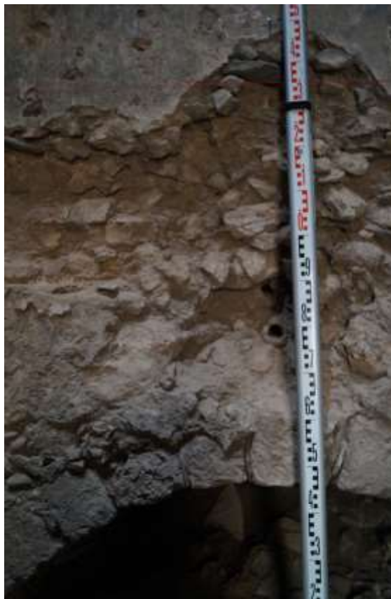
3. Θερμή αίθουσα (Θ). Δυτικός τοίχος. Λόγω τοπικής κατάρρευσης της τοιχοποιίας, διακρίνονται δύο αγωγοί που ξεκινούν από την κεντρική δεξαμενή (Δ1).
