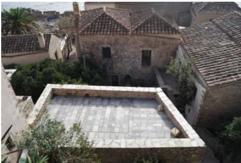
14. Ιδιοκτησία Αθανασιάδη Π. Από τη βόρεια πλευρά. (Το δεξί κτήριο από τα δύο με τις τετράρριχτες στέγες) Χαμηλά, κάτω από άνοιγμα του ορόφου βρίσκεται το σημείο που θα εξεταστεί.
