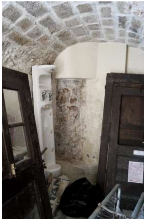
4. Κτήριο ιδιοκτησίας Λαζαρέτο Α.Ε. Ισόγειο. Πιθανή εστία στη ΝΔ γωνία που έχει σφραγιστεί με λίθους,
