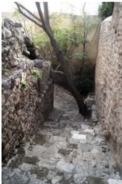
11. Καλντερίμι πίσω από το Τζαμί. Διακρίνεται γένεση καμάρας.
