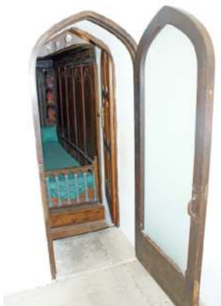
3. Δύο πόρτες κατά το πάχος του τοίχου σε άνοιγμα προς θερμό χώρο. Κτήριο του Villagarut. Ρόδος. Πηγή: Καραγεώργη, Ε. (2014), σ.82
