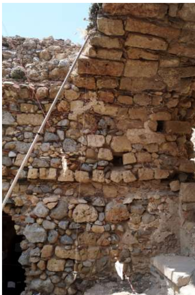
13. Ψυχρός χώρος –αποδυτήριο (Ψ). Ανατολική καμάρα. Κακό χτίσιμο από ένα ύψος και πάνω του θόλου. Χαμηλά τρύπα στην τοιχοποιία που έχει φραχθεί. Ψηλότερα σκαλότρυπες.
