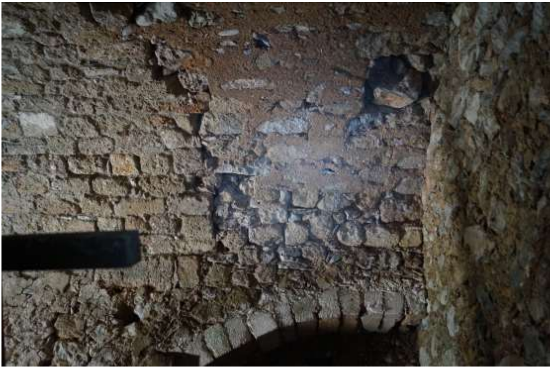
49. Ναός Σωτήρος – χώρος τροφοδοσίας (ΝΣ). Ξαναχτισμένο τμήμα του θόλου μετά από την ανέγερση του λουτρού.
