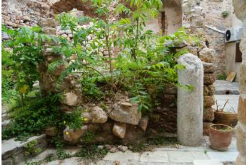
1. Ανεξέλεγκτη βλάστηση στους τοίχους του μνημείου.
