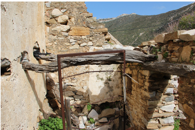
Εικ.66 Καταστροφή ξύλινου Φ.Ο. στέγασης βοηθητικών κτισμάτων
