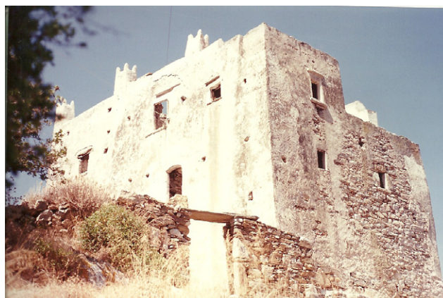
Εικ.71 Τμήμα τοίχου και απόληξη τα οποία έχουν καταρρεύσει πηγή: αρχείο του Ι.Κ. Τουμπακάρη, Απρ. 1984
