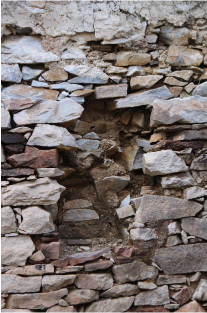
εικ.52 επίτοιχο ερμάριο στο βορειοδυτικό τοίχο στο επίπεδο E2
