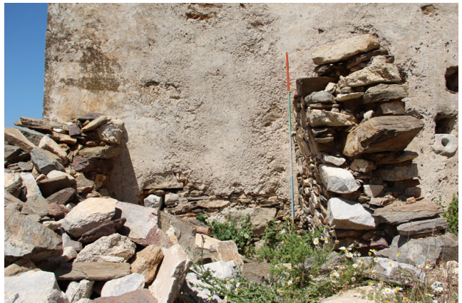
Εικ.67 Κατάρρευση τοιχοποιιών των βοηθητικών κτισμάτων
