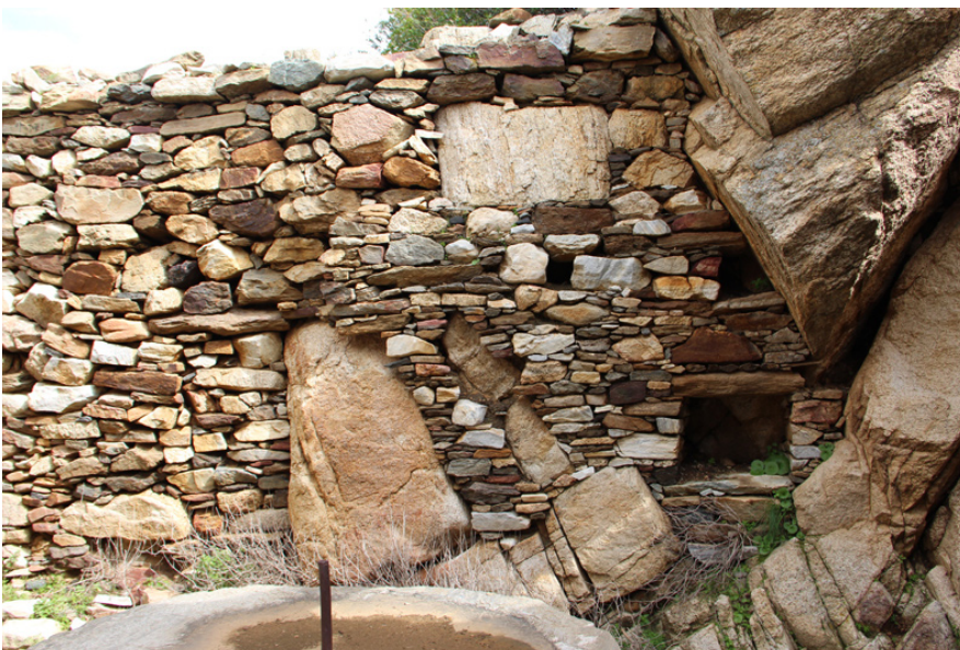
Εικ.95 Εσωτερική παρειά βορειοανατολικής τοιχοποιίας ελαιοτριβείου. Διακρίνεται ο βράχος που αποτελεί μέρος της τοιχοποιίας
