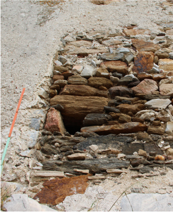
Εικ.78 Αρμός μεταξύ Β' και Γ' οικοδομικής φάσης
