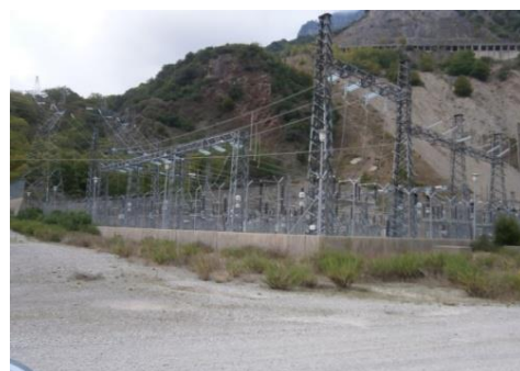
Εικόνα 29: Σταθμός παραγωγής Γλύστρας σήμερα
