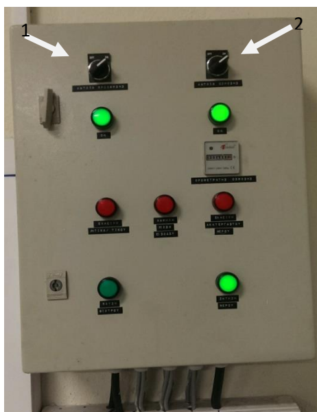
Εικόνα 2. Πίνακας Ισχύος Αυτοματισμού RO
