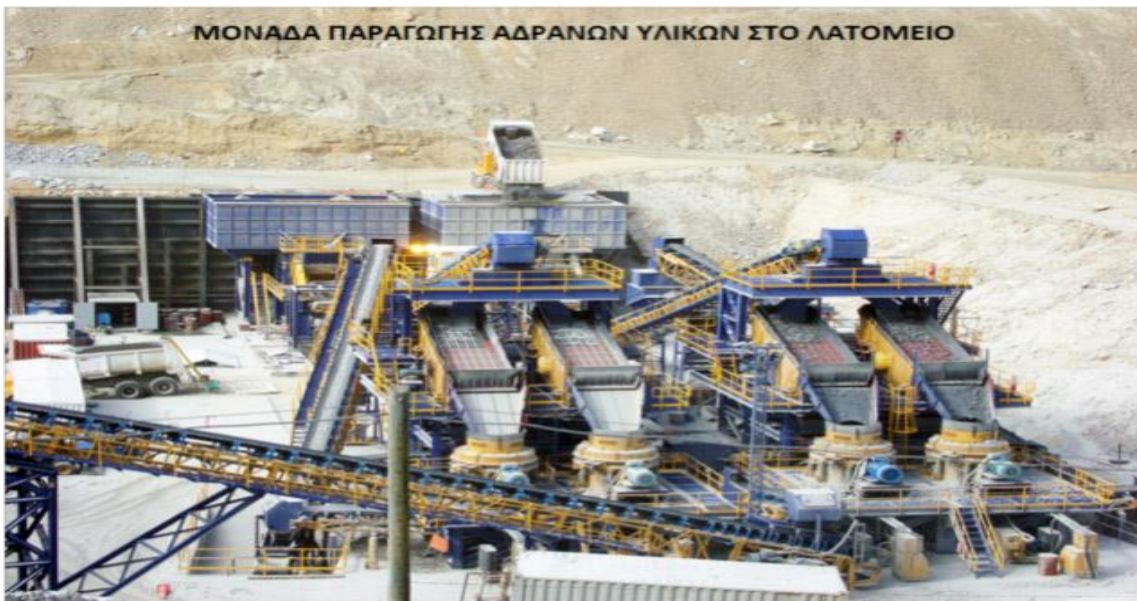
Εικόνα 1.10 Μονάδα παραγωγής αδρανών υλικών (σταθερό συγκρότημα) [Πηγή: [12]]
