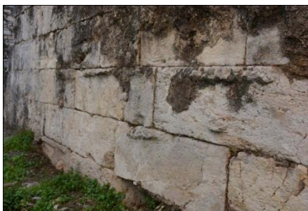
Εικ.100., Κατάλοιπα άπεργου κατά μήκος των ακμών των λίθων
