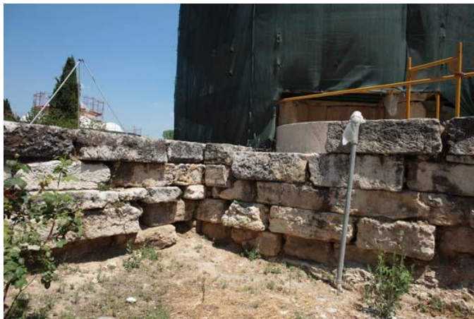
Εικ.112, Αποσάθρωση των πώρινων δόμων στις χαμηλότερες στάθμες των θεμελιότοιχων
