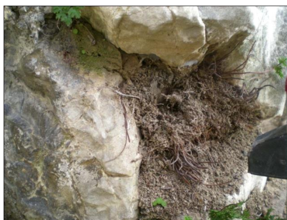
Εικ.120., Αυτοφυής βλάστηση στον αρμό ώσεως μεταξύ των τόξων T2 και T3
