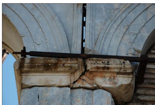
Εικ.108, Θραύση, διαμπερές ρήγμα στο μέσον του επικράνου ΕΠ1
