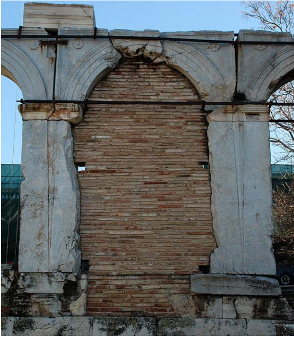
Εικ.43 . Η δυτική όψη του τοίχου πλήρωσης του μεσαίου ανοίγματος
