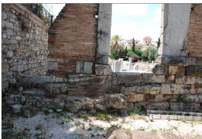
Εικ.48 , Η ανατολική όψη της αντηρίδας. Διακρίνεται η επισκευή του δυτικού θεμελιότοιχου στη βάση της αντηρίδας.
