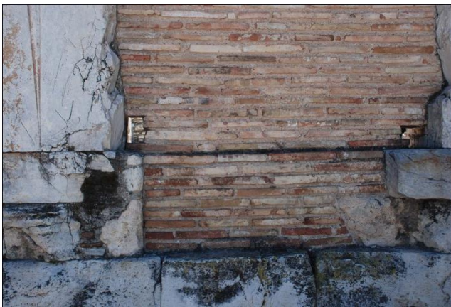
Εικ.45 . Λεπτομέρεια από τη διεύρυνση της βάση του τοίχου πλήρωσης του μεσαίου ανοίγματος
