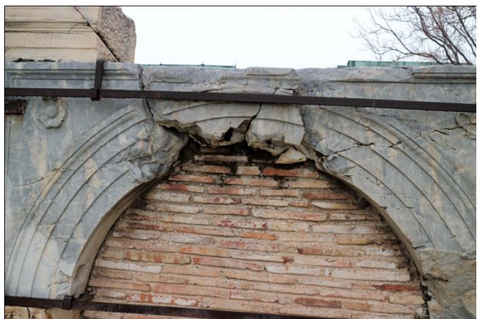
Εικ.105, Αστοχία του τόξου T1 στην κορυφή του
