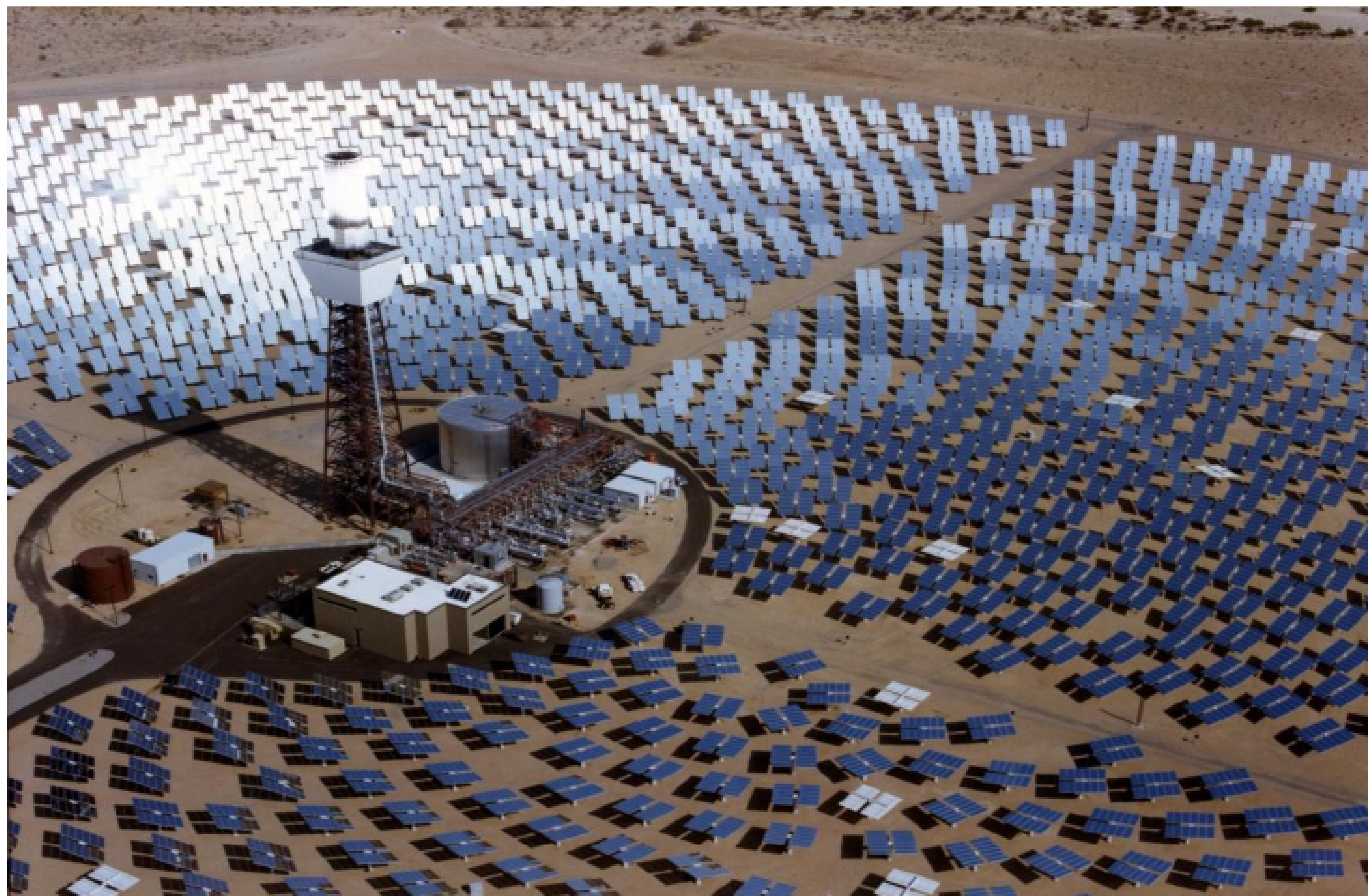
Εικ. 4.10 : Εναέρια φωτογραφία του Solar Two στο Barstow της Καλιφόρνια.
