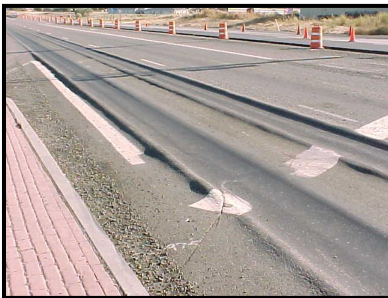
Εικόνα 2.1.: Τροχοαυλάκωση στο οδόστρωμα (Google)
