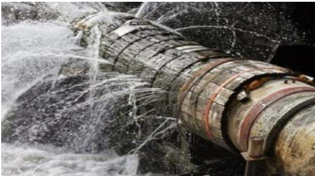
Εικόνα 2:Διαρροήαγωγού στη Λευκάδα. (Πηγή: www.offsite.com.cy )
