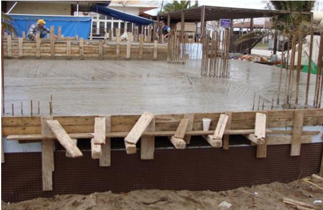
Εικόνα 4.4: Αστυνομικός κατά τη στιγμή της άφιξής του στο εργοτάξιο και επί τόπου διαπίστωση τέλεσης αυθαίρετης εργασίας σκυροδέτησης
