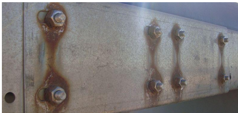
2.1.1 Ηλεκτροχημική διάβρωση λόγω διαφοράς δυναμικού της επιφάνειας με τους κοχλίες
