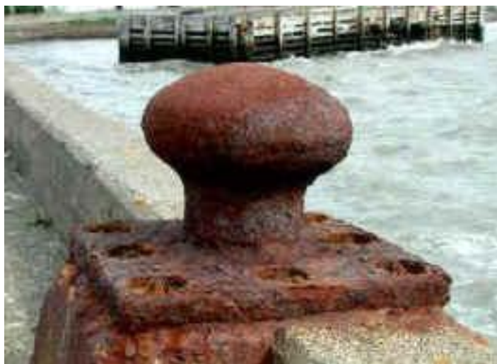
2.2.1 Ομοιόμορφη ή γενική διάβρωση (General Corrosion)
