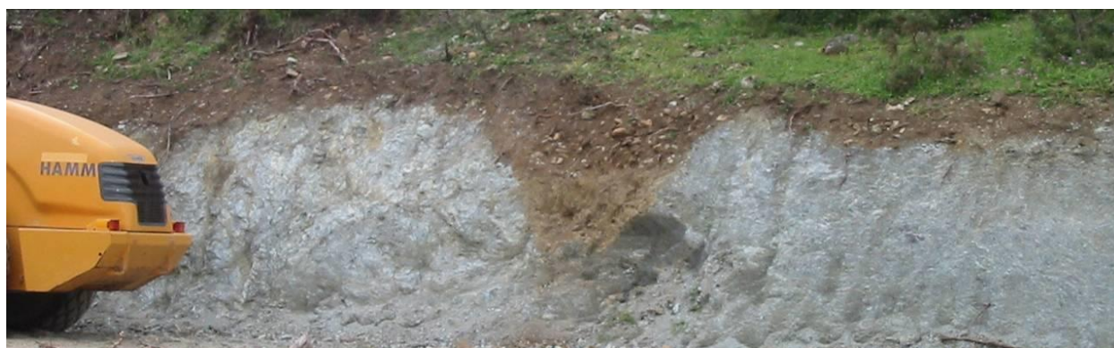
Φωτογραφία 15.4. Αργιλοαμμώδες κάλυμμα με χάλικες πάνω από αποσαθρωμένο σερπεντινίτη σε πρανές εκσκαφής για την περιμετρική οδό του ταμιευτήρα του φράγματος.
