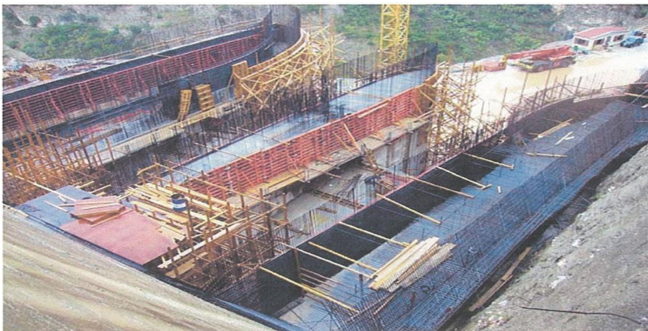
Εικόνα 2-11: Θυροφράγματα-Λήψη από πάνω(Πηγή:ΔΕΗ)
