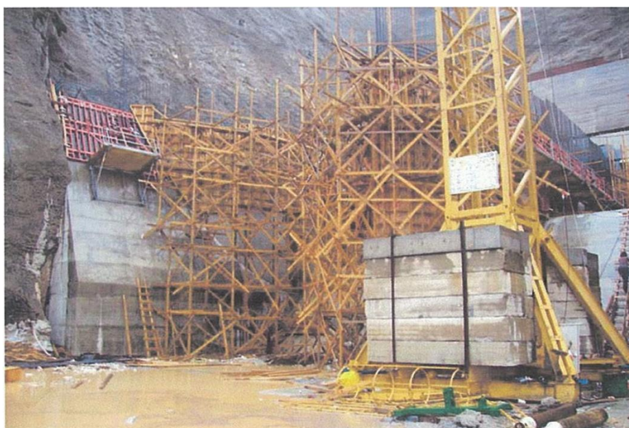
Εικόνα 2-12: Θυροφράγματα – Λήψη από μπροστινό μέρος (Πηγή:ΔΕΗ )
