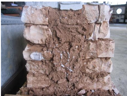
Εικόνα 8.23: Αστοχία ενδιάμεσης στρώσης με κατακόρυφες ρωγμές σε όλο το ύψος.
