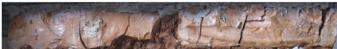
Εικόνα 8.28:Στον αριστερά λίθο παρατηρείται ρωγμή στο κέντρο με μεγαλύτερο εύρος στο κάτω τμήμα του. Στον δεξιά ρωγμή περί το κέντρο με μεγαλύτερο εύρος στο κάτω τμήμα του και ρωγμές στα άκρα με μεγαλύτερο εύρος στο πάνω τμήμα του ( ομοιότητα με αμφίπακτο στοιχείο).
