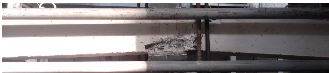
Εικόνα 3.37: Το υποστύλωμα Y2 στη μετατόπιση +5 \cdot \delta_y μετά από τρεις ανακυκλίσεις
