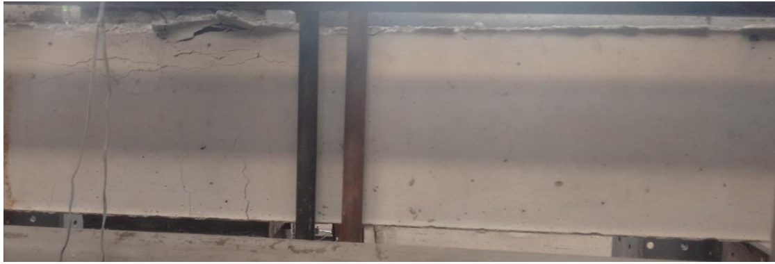
Εικόνα 3.31: Ρηγμάτωση του Y1 στην μετατόπιση 2·δ y , 1 ος κύκλος (πάνω) και στην -2·δ y , 2 ος κύκλος (κάτω)
