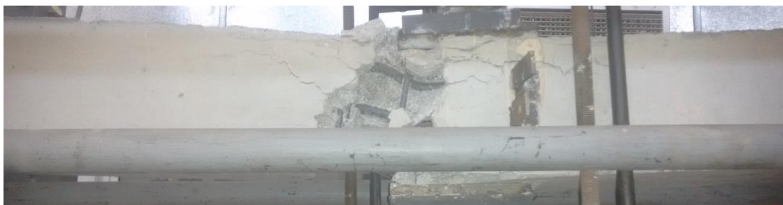
Εικόνα 3.33: Παραμόρφωση διαμήκων ράβδων οπλισμού μετά την τελική αστοχία
