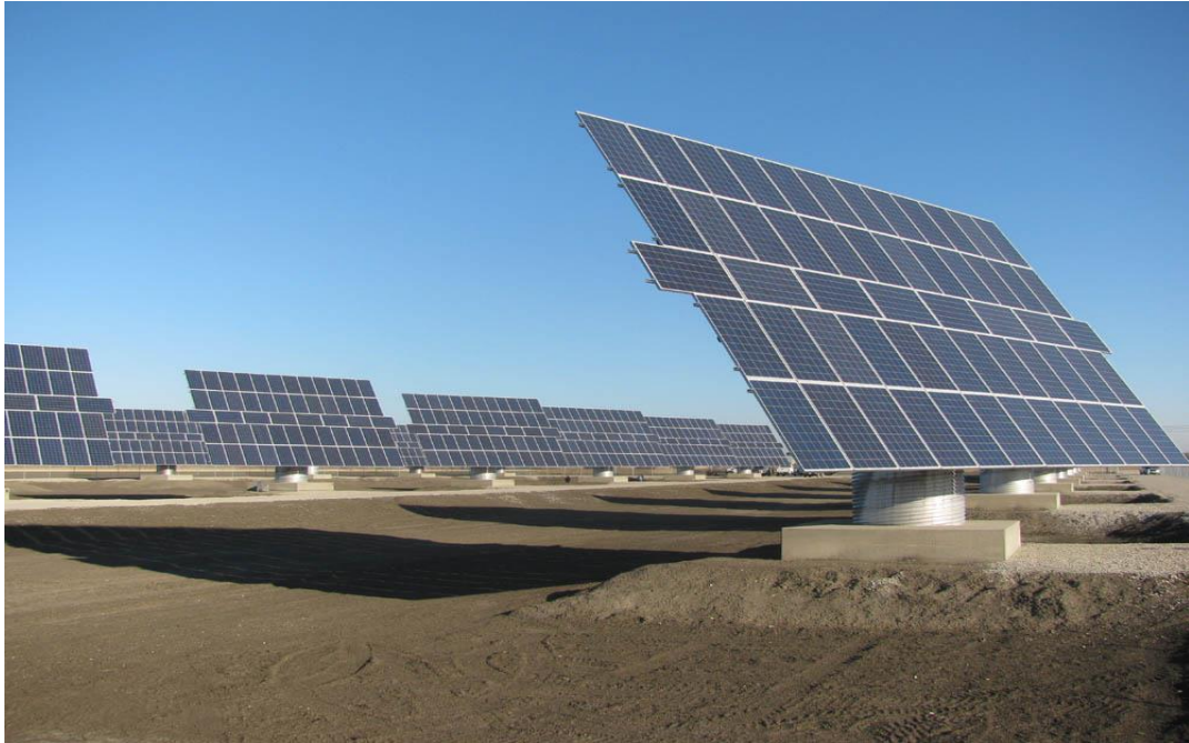
{Εικ. 2.18} Φωτοβολταϊκά συστήματα στη περιφέρεια Madera της Καλιφόρνιας
