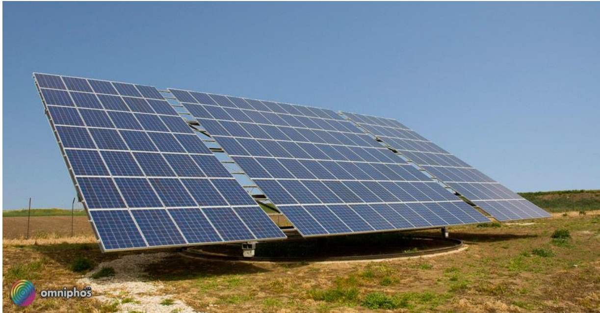
{Εικ. 2.1} Φωτοβολταϊκό σύστημα σε τοποθεσία λίγο έξω από την Λάρισα
