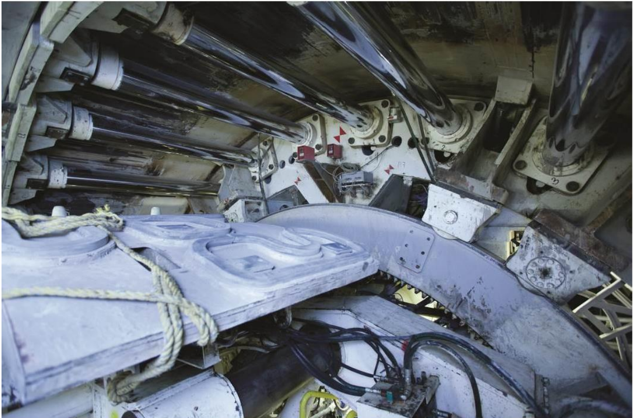
Εικόνα 1.9 Τα έμβολα ωθήσεως εφαρμόζουν στα στοιχεία οπλισμένου σκυροδέματος ωθώντας το EPB προς το μέτωπο ( http://www.therobbinscompany.com )
