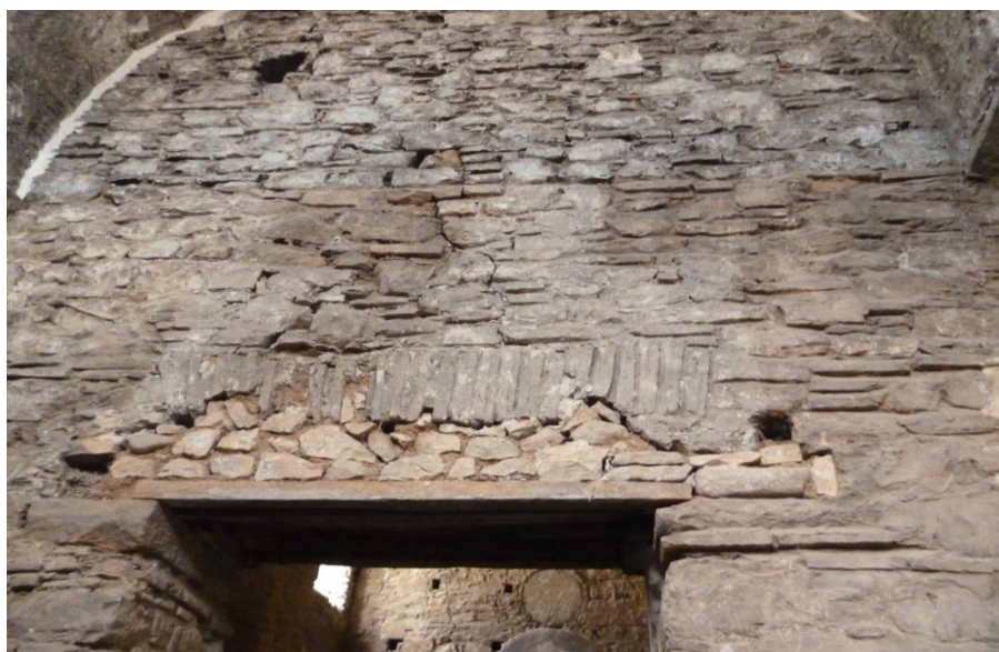
Εικόνα 3.13: Τοίχος του νάρθηκα όπου υπάρχει διαμπερής ρωγμή.
