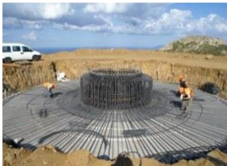
Σχήμα 1.12 Μορφή θεμελίωσης με τοποθέτηση, εντός του σώματος του θεμελίου, κυλινδρικού σώματος αγκύρωσης. Εικόνα πριν τη σκυροδέτηση.
