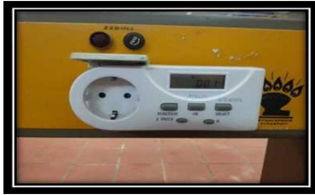
Εικόνα 20: Μετρητής καταναλισκόμενης ενέργειας
