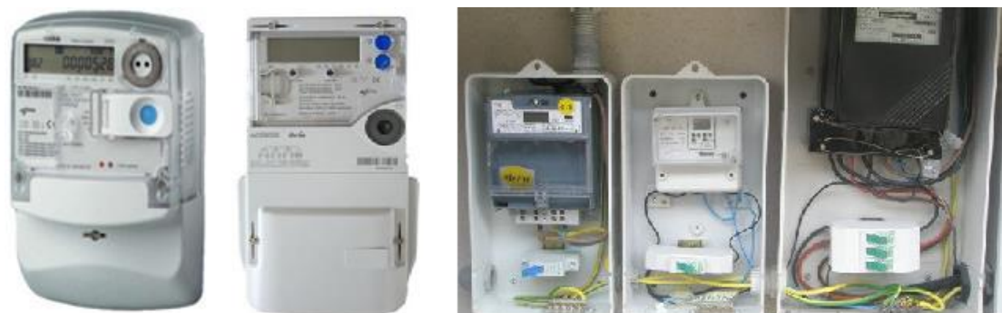
Εικόνα 2.7: Ηλεκτρονικός μετρητής χαμηλής τάσης
