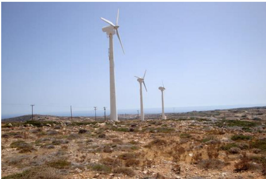
Φωτογραφία 3.2 Ανεμογεννήτριες στο αιολικό πάρκο του Αγίου Ιωάννη [29]
