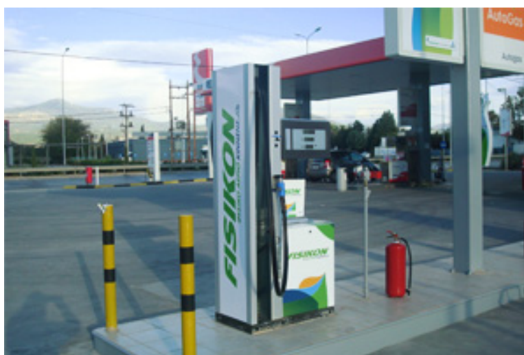
Εικόνα 28 : Αντλία τροφοδοσίας (CNG) σε πρατήριο υγρών καυσίμων στην Πυλαίας
