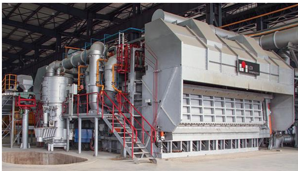
Εικόνα 1.7 Σταθμός παραγωγής δευτερόχυτου αλουμινίου διπλού θαλάμου.
