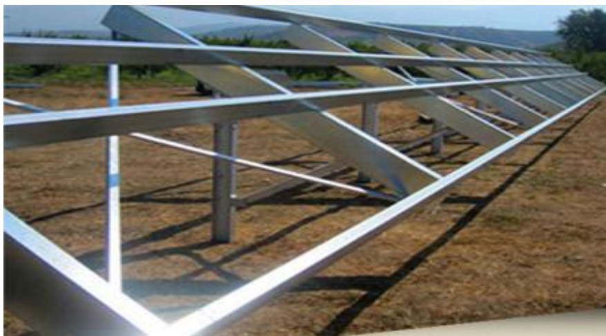
Εικόνα 2.5: Βάσεις στήριξης φωτοβολταϊκών πάνελ ανοιχτού χώρου [19]
