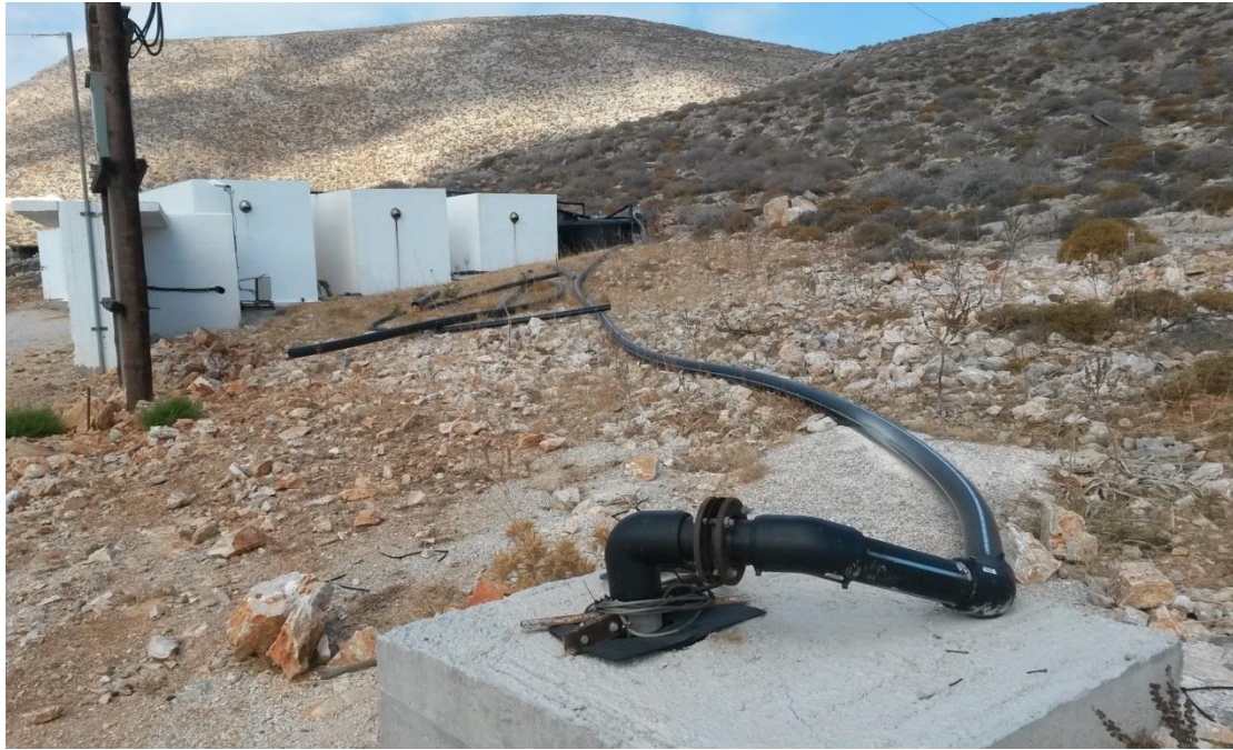
Εικ. 4.3: Σημείο άντλησης θαλασσινού νερού
