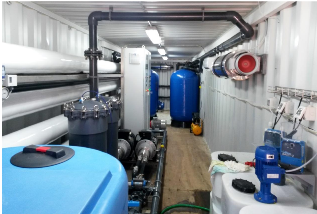
Εικ. 4.2: Εσωτερικό μονάδας αφαλάτωσης
