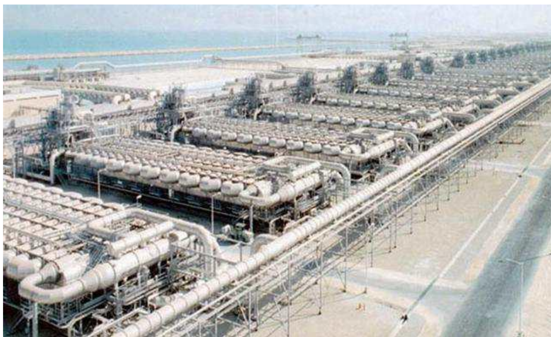
Εικ. 5.2: Μονάδα πολυβάθμιας εκτόνωσης στη Μέση Ανατολή
