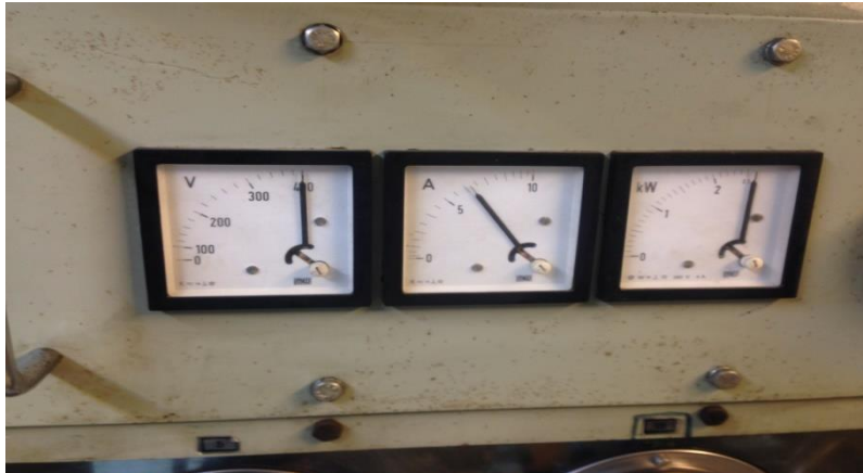
Εικόνα 4.15 Ενδείξεις ηλεκτρικών μεγεθών στο παλιό κύκλωμα (βαλβίδα 11)
