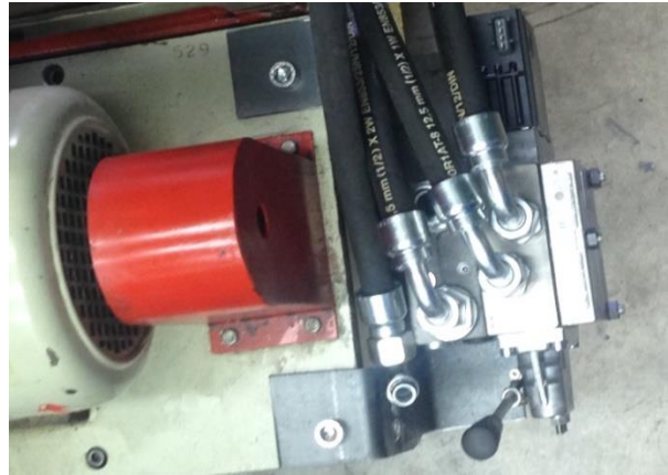
Εικόνα 3.28 εγκατεστημένο PVG 32 στη HERION
