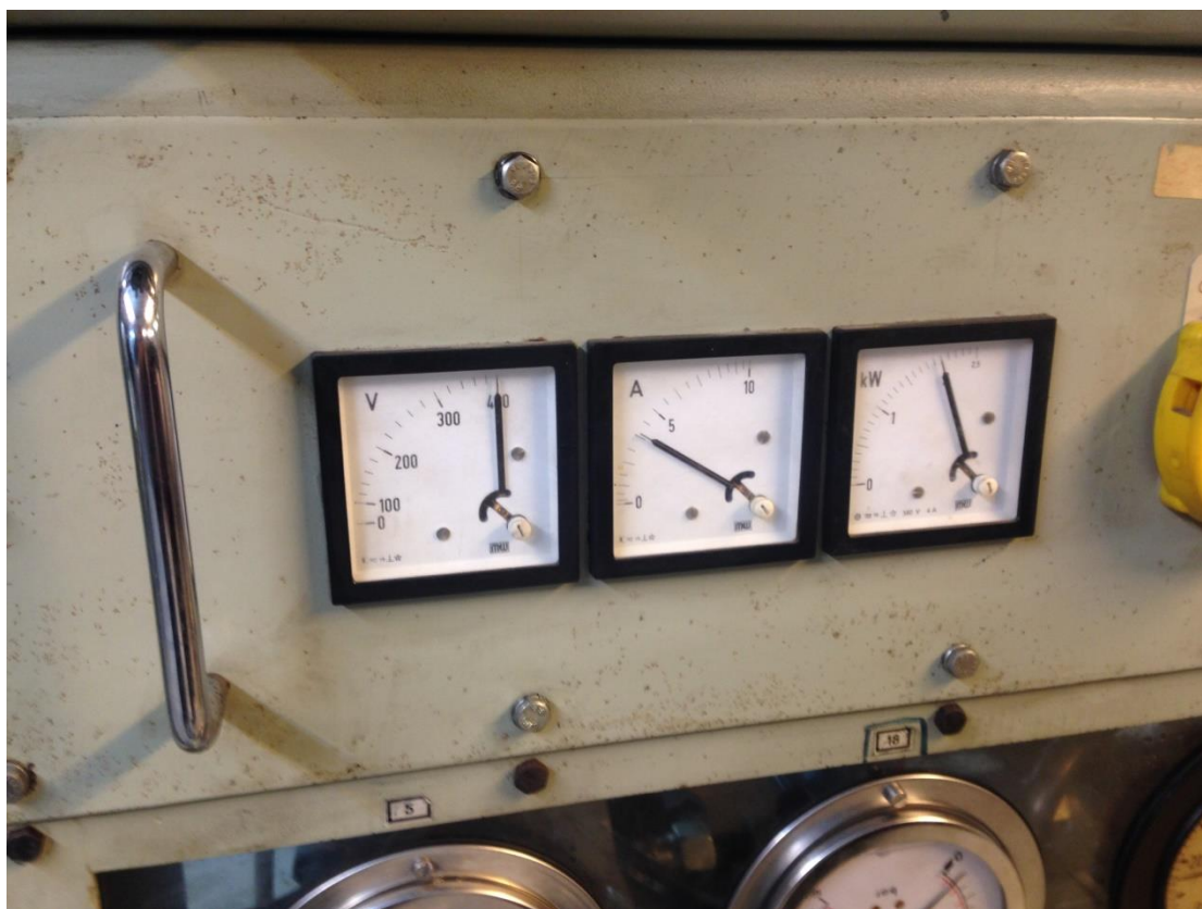
Εικόνα 4.21 Ενδείξεις ηλεκτρικών μεγεθών στο νέο κύκλωμα (βαλβίδα PVG)
