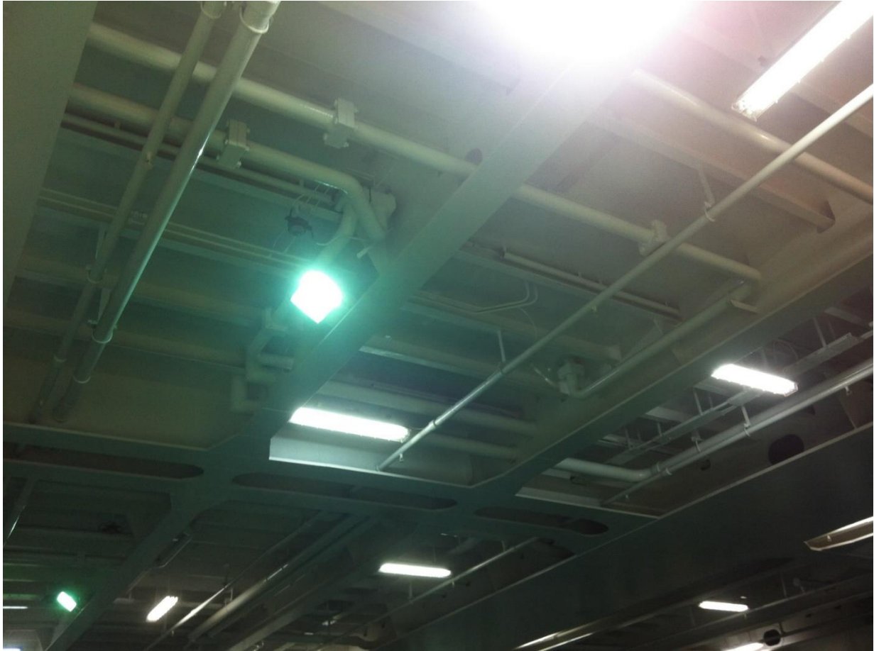
Σχήμα 6.13: Διάταξη ενισχυτικών και σωληνώσεων (Φωτογραφία από το Ε/Γ-Ο/Γ Έλυρος)
