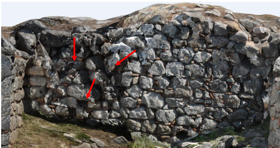
Εικόνα 5-32: «Λεκέδες» σε περιοχή με τείχη.
