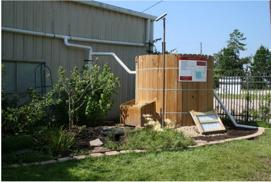
Εικόνα 3.10 Υπέργεια ξύλινη δεξαμενή αποθήκευσης βρόχινου νερού (Πηγή: http://rainwaterharvesting.tamu.edu/files/2012/08/Aboveground.jpg )
